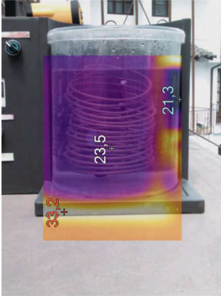
Imagen térmica del condensador
