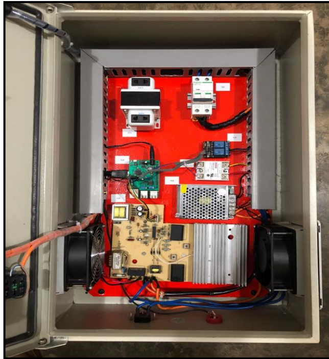
Figura 20. Vista Real interna de tablero eléctrico
