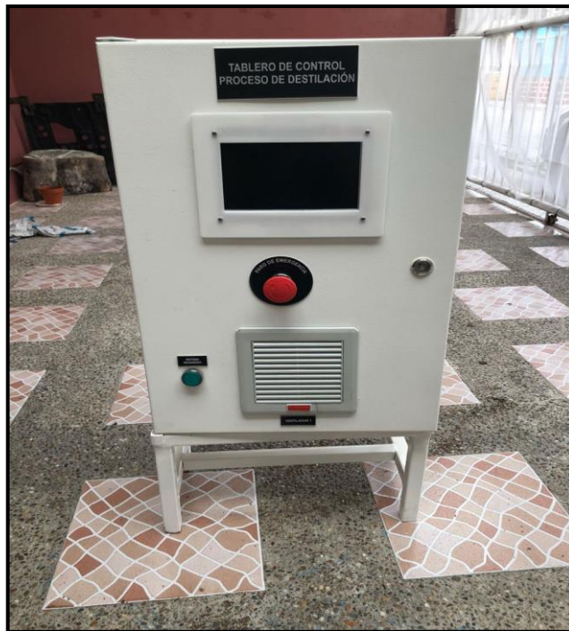
Figura 21. Vista externa de tablero eléctrico
