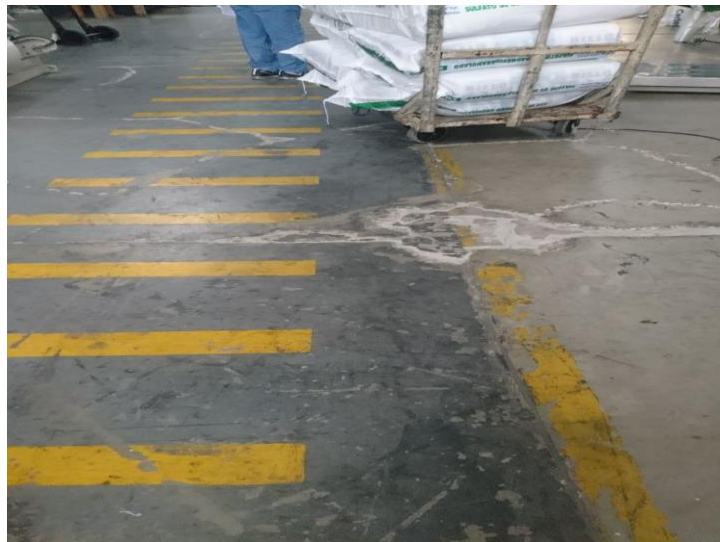
Figura 15.- Líneas de tránsito peatonal desmarcadas
