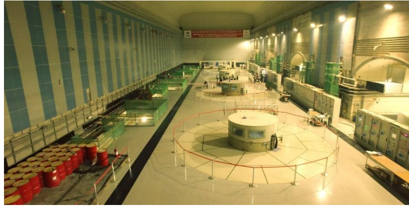
Figura 73: Hidroeléctrica Coca Codo Sinclair.
