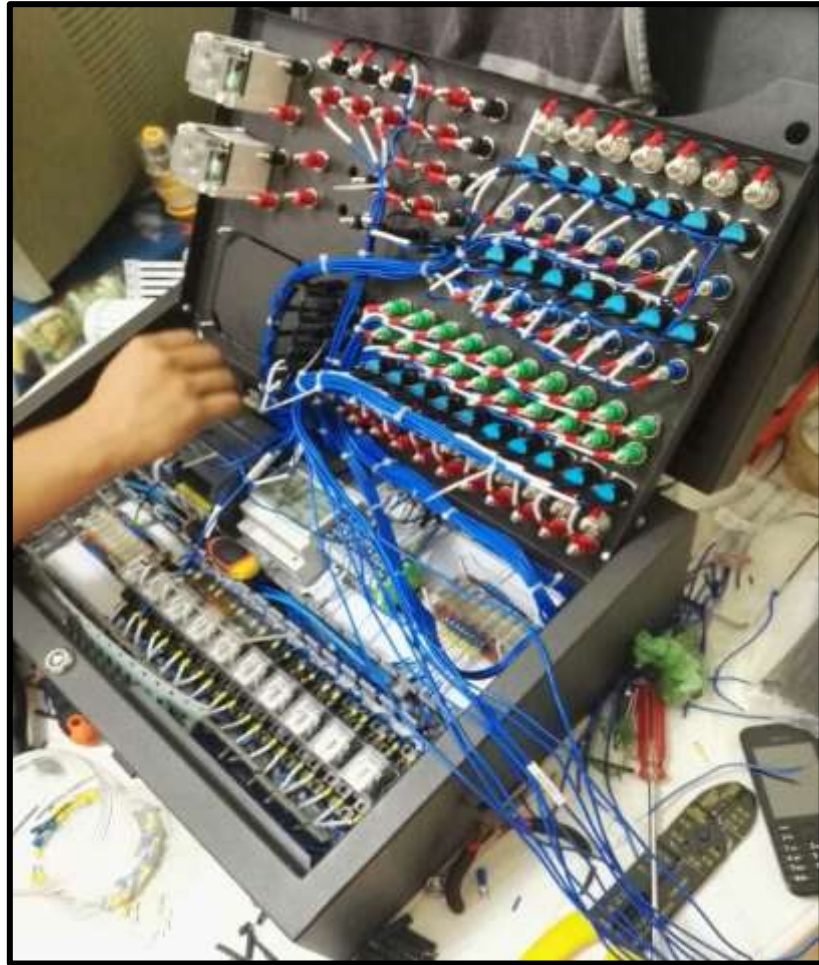
FIGURA 38: CABLEADO DEL MÓDULO DIDÁCTICO.
