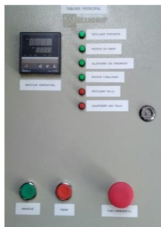
Figura 17. Tablero de Control
