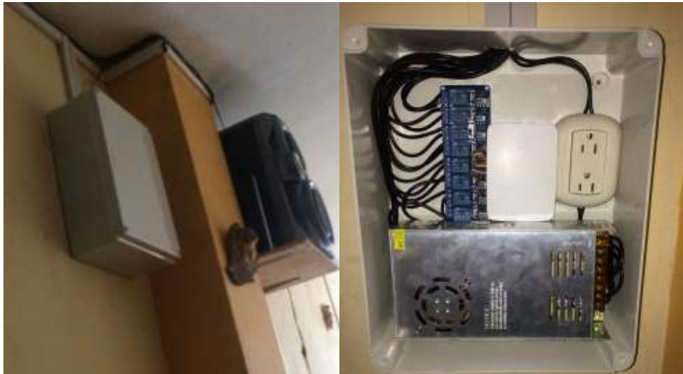
Figura 70: Panel de distribución de sistema domótico.
