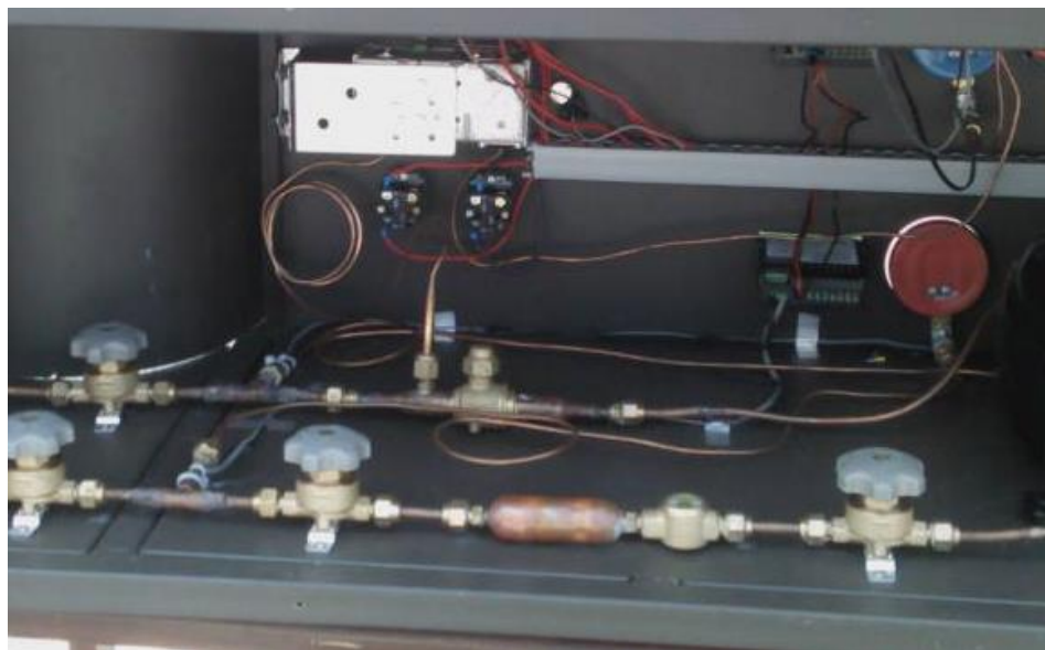
Figura A 6.11. Imagen de luz visible de las tuberías.
