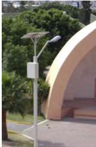
Figura 4. 14. Alumbrado público con sistema fotovoltaico autónomo. ( Esco-tel, 2017 )
