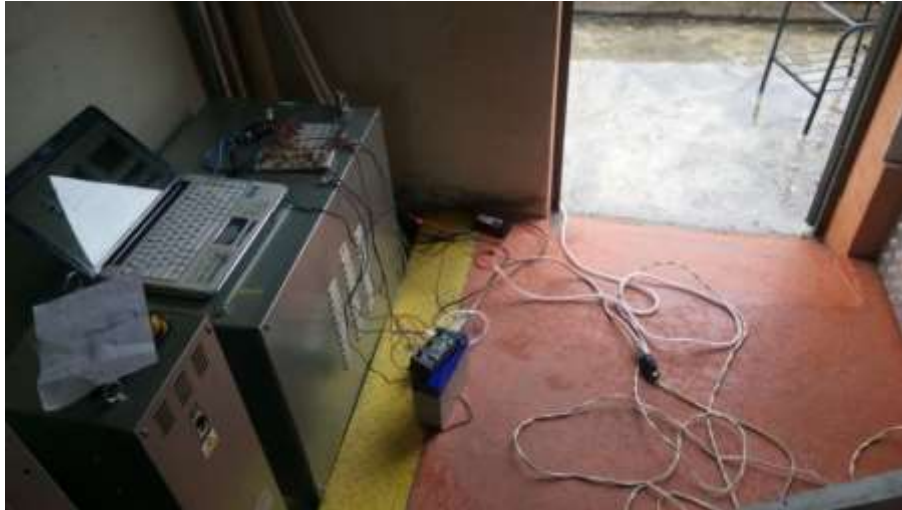
Figura 3. 5. Instalación en el cuarto de ascensores, en la terraza del Edificio Guillermo Mensi de la UPS Cuenca, día lluvioso.
