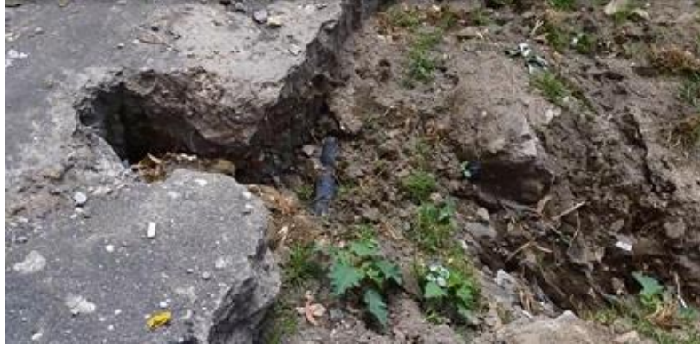
Figura 20. Manguera desenterrada debido a erosión. Elaborado por: David Rosado.
