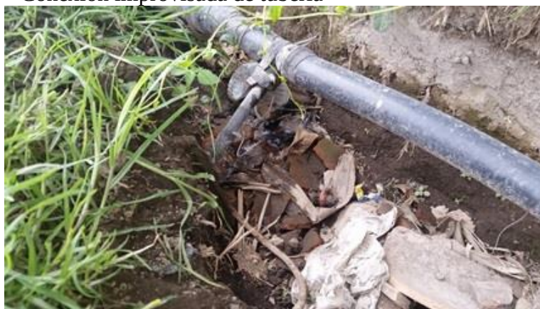
Figura 23. Conexión improvisada de tubería. Elaborado por: David Rosado.
