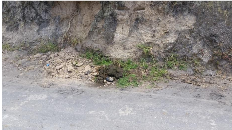
Figura 21. Fuga de agua en el recorrido de la tubería. Elaborado por: David Rosado.
