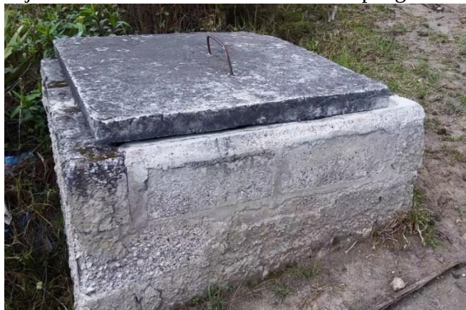
Figura 11. Caja de revisión en la distribución de Apangora. Elaborado por: David Rosado.
