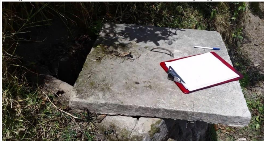
Figura 13. Caja de revisión de la distribución de fuente Apangora. Elaborado por: David Rosado.
