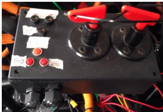
Figura 33 Montaje de caja de interruptores maestros, puntos de medición y pulsadores de reinicio. [5]
