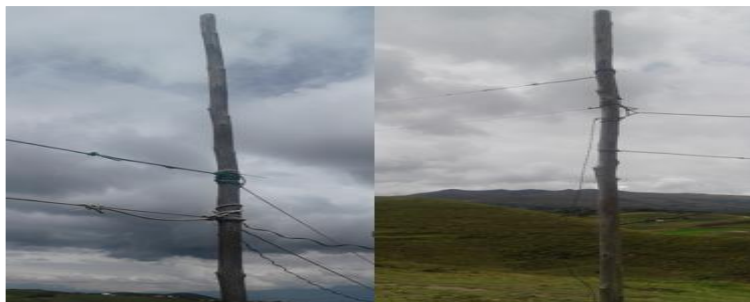
Figura 2. 11 Condiciones de conexión del tendido eléctrico en la zona Elaborado por: Tania Aguirre y Rodrigo Suárez
