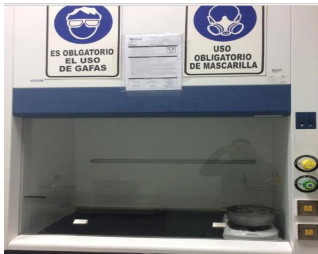
Fotografía 10: Cámara de extracción aire
