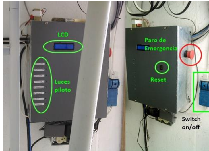
Elementos del tablero eléctrico. Elaborado por: El autor.
