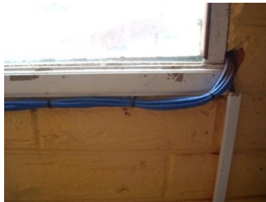
Figura: cableado de la red de cámaras utilizando cable UTP categoría 5e (Andrade, 2015)
