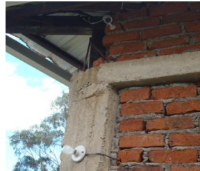
Figura: Cámara CA4 colocada para la vigilancia del Tanque de distribución de DIESEL (Andrade, 2015)
