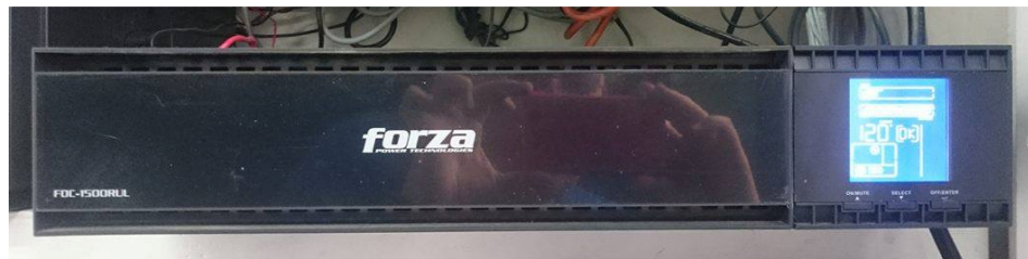
Figura 28. Instalación de UPS.
