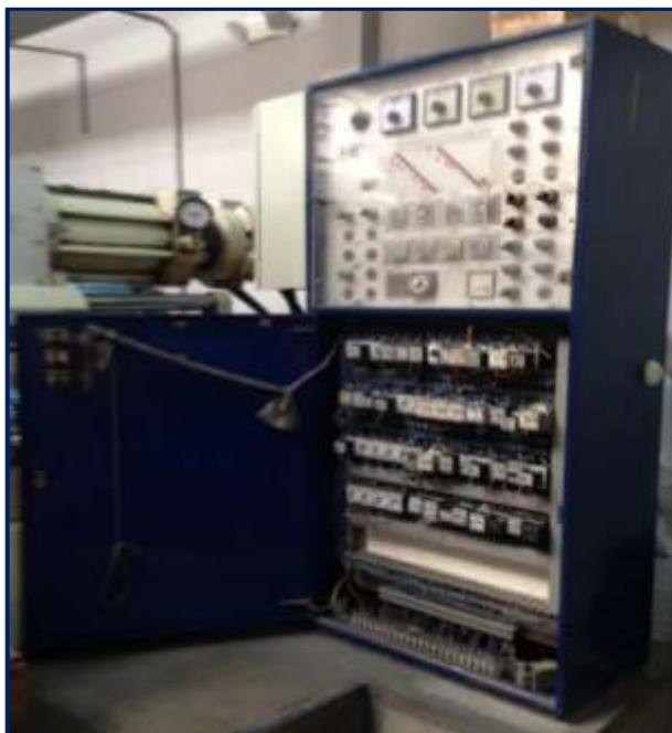
Figura 1. Tablero de Control Inicial de Inyectora MIR.
