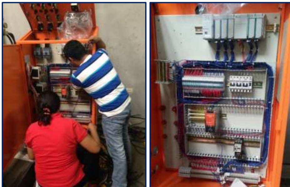
Figura 44. Conexión de elementos en el nuevo tablero de control.
