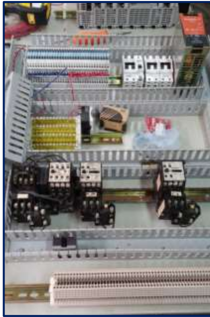
Figura 43. Ubicación de elementos de control y fuerza en el nuevo tablero de control.
