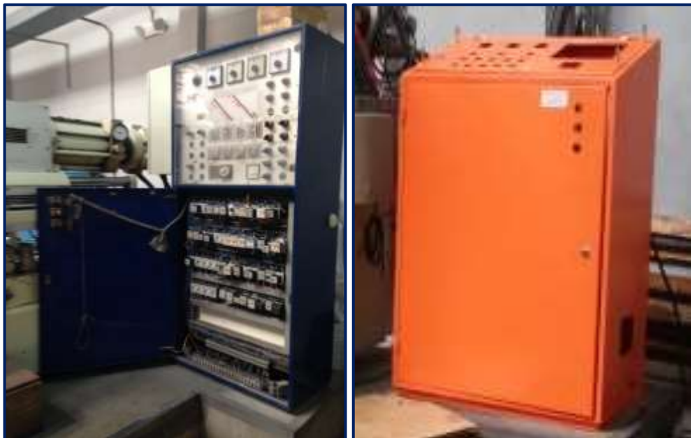
Figura 40. Tablero de control viejo (izq.). Tablero de control nuevo (der).
