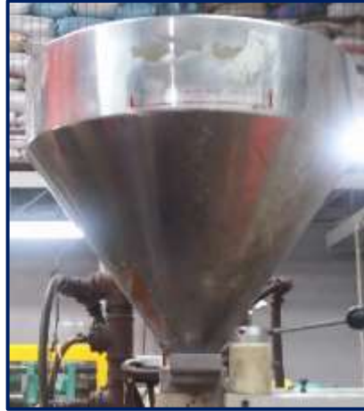
Figura 8. Tolva donde se ingresa la materia prima a fundir.
