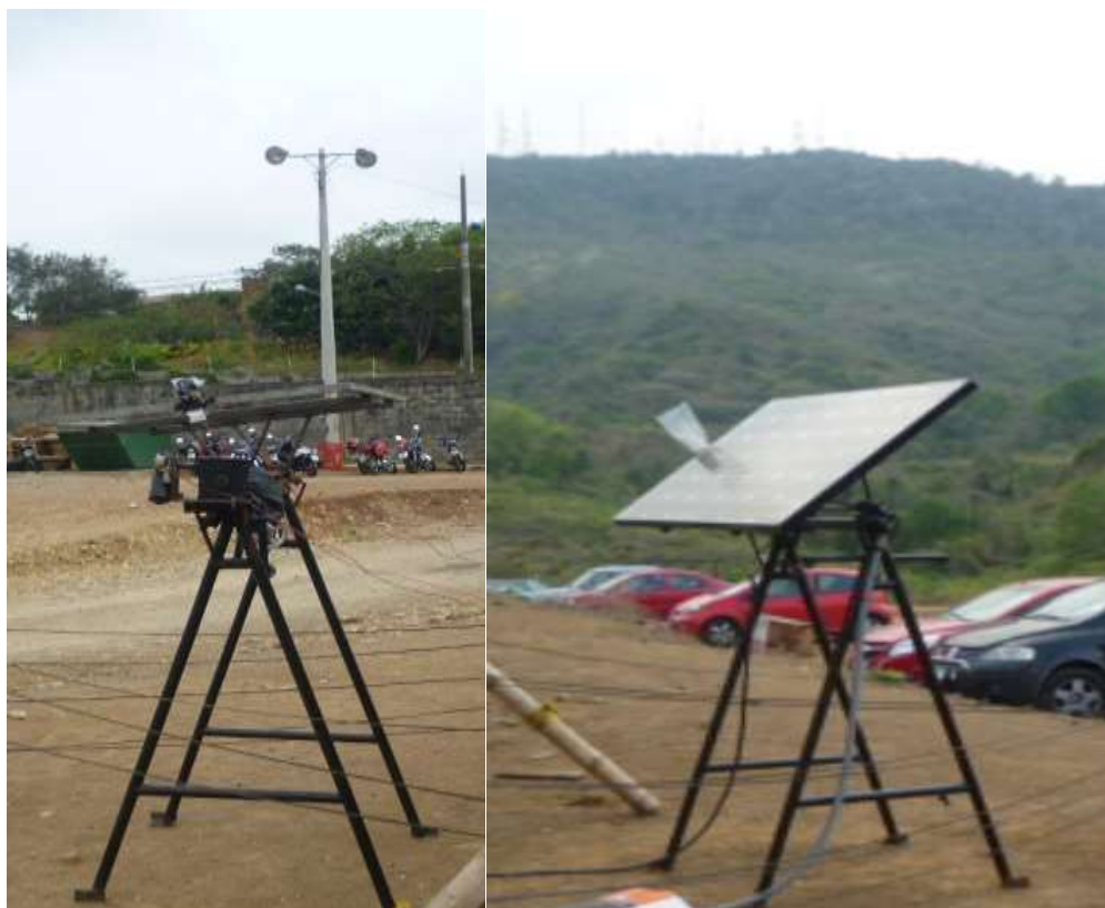
Figura 32. Estructura del Panel solar.
