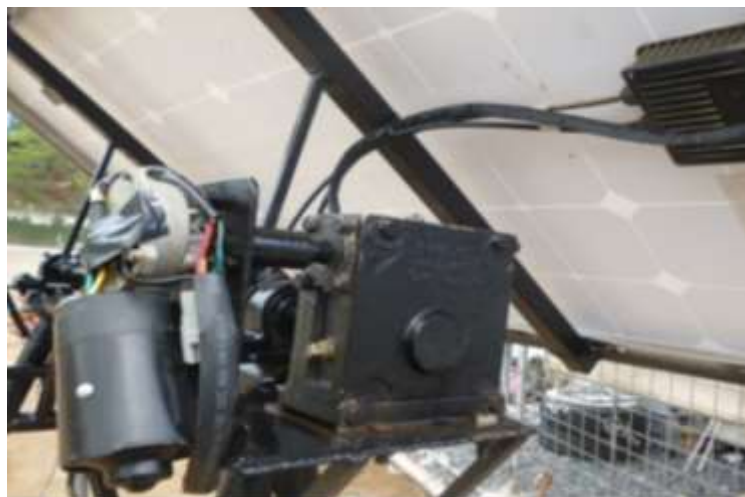
Figura 30. Acople entre la caja reductora y el motor DC.
