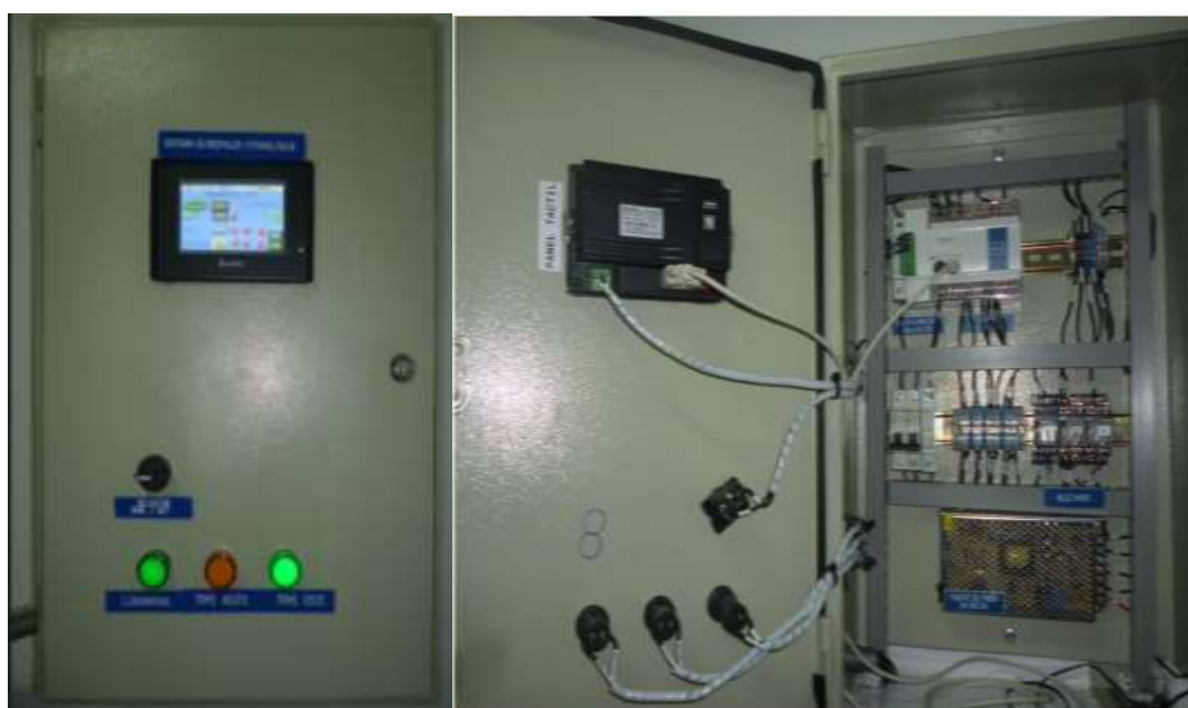
Figura 34. Tablero de Control.
