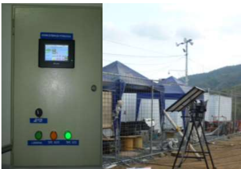
Figura 43. Ubicación final del Sistema Fotovoltaico.
