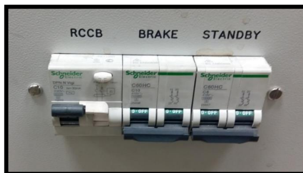
Fig 19: Switch Fuente: Autores
