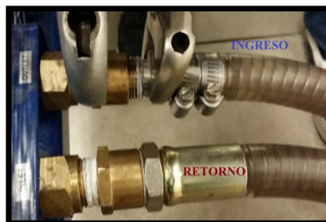
Fig 37: Mangueras de ingreso y retorno del refrigerante del intercambiador de calor Fuente: Autores
