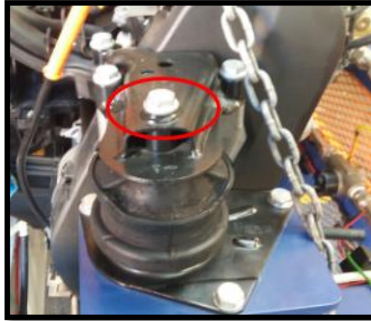
Fig 43: Desacople de la Estructura de soporte 1 con el motor Fuente: Autores
