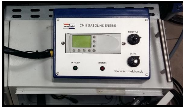
Fig 93: Unión del controlador lógico con el gabinete electrónico Fuente: Autores
