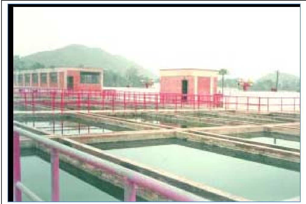
Decantador de manto de lodos
