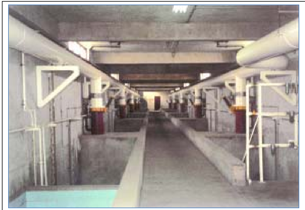
Galería de tubos de filtros de patente
