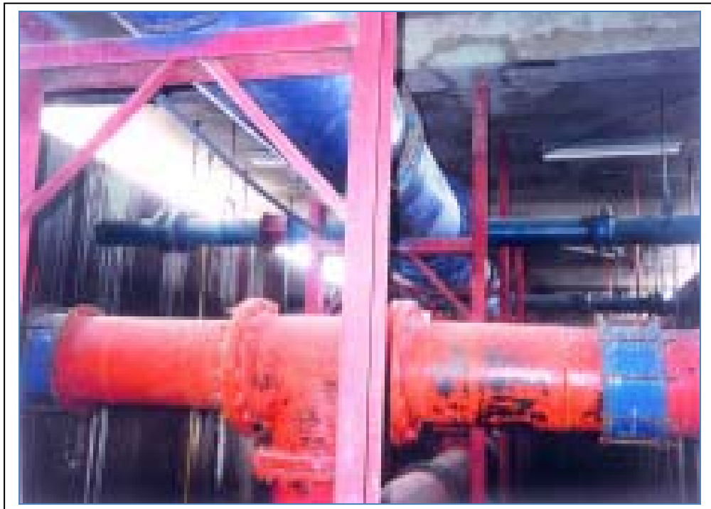
Galería de tubos convencional
