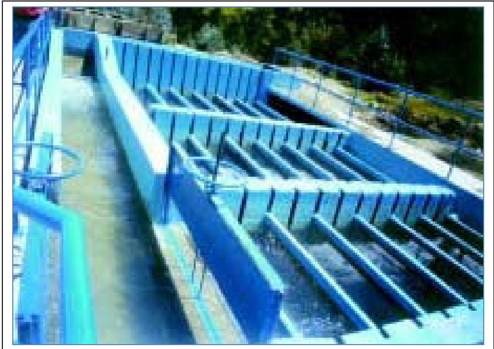
Floculadores hidráulicos de flujo vertical
