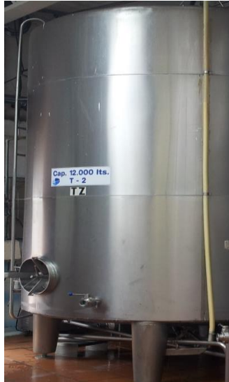
Figura 1.12 Silo de Almacenamiento T2.
