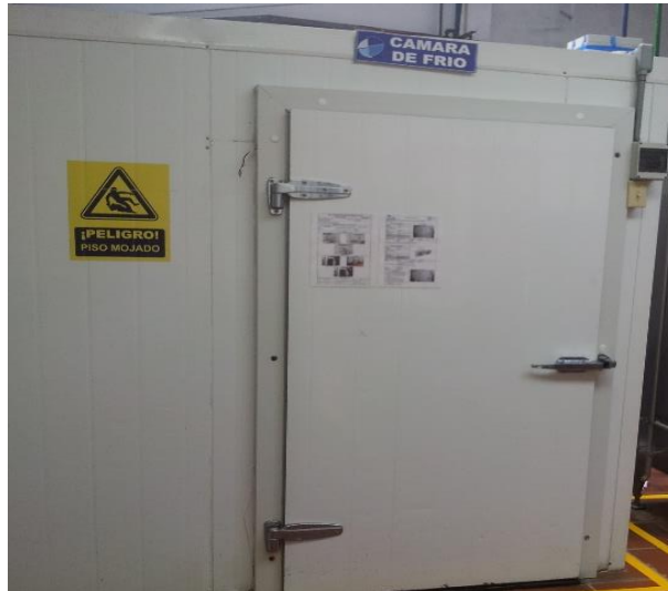
Figura 1.9 Cámara de Frio.
