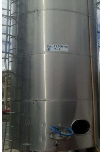
Figura 1.13 Silo de Almacenamiento T6.
