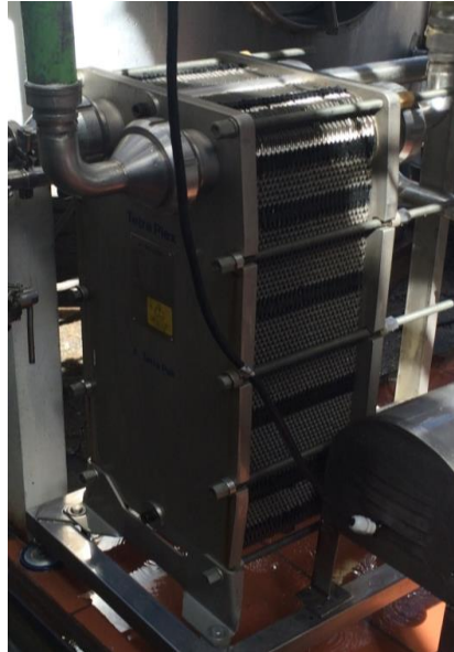
Figura 1.18 Intercambiador de placas.
