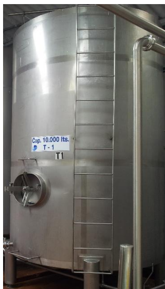
Figura 1.11 Silo de Almacenamiento T1.
