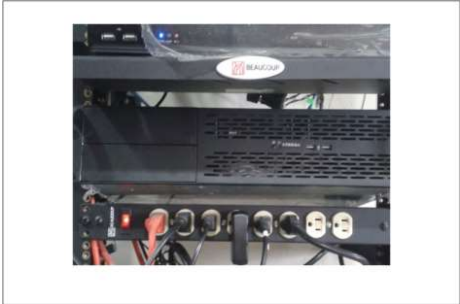
Imagen 14: Servidor de telefonía IP bodega central (Inmaconsa). Fuente: El Autor
