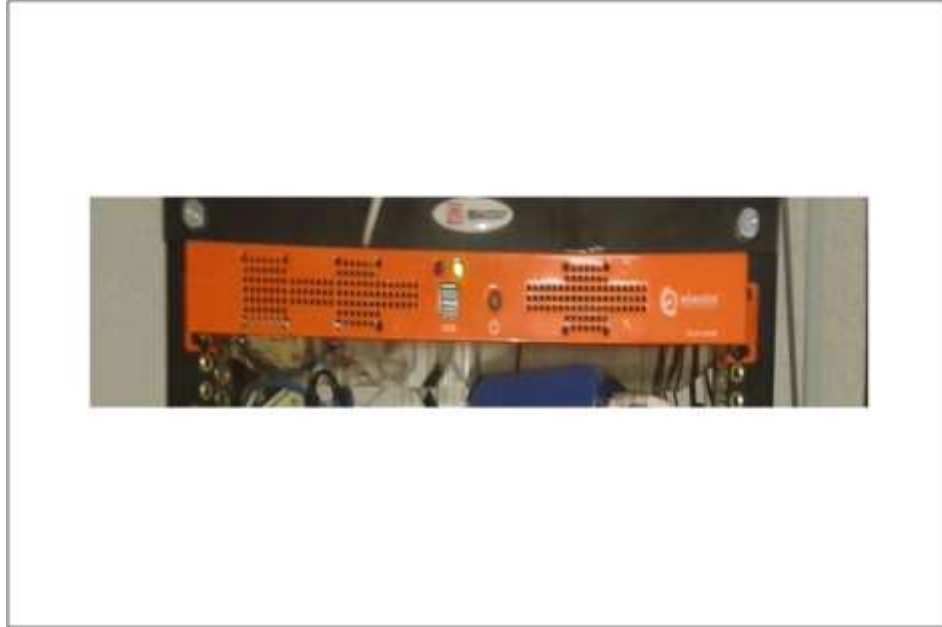
Imagen 16: Servidor de telefonía IP Quito. Fuente: El Autor
