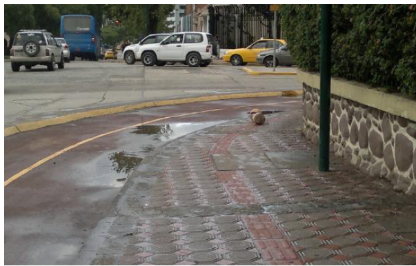
Ilustración 19. Fin de acera en intersección. Av. 10 de Agosto.
