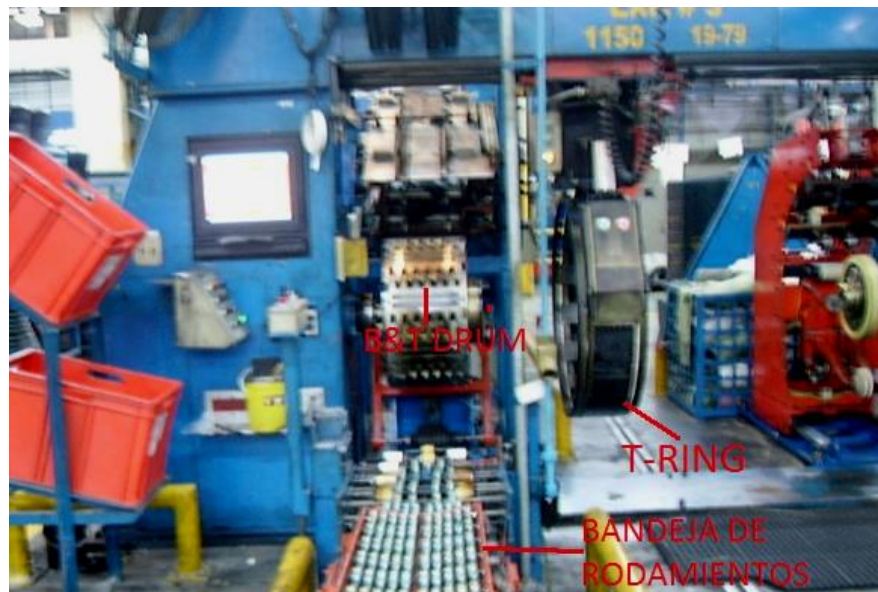
Fig. # 31 Sección de conformación paquete de breaker.
