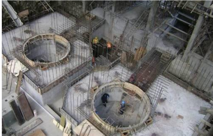
Figura No.2.14 Casa de Máquinas. 17
