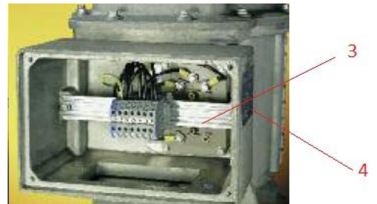
Figura No. 3.53 Caja de Conexiones. 53
