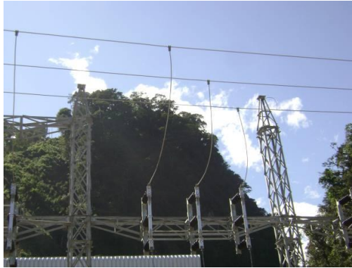
Figura No.2.18 Línea de Transmisión. 21
