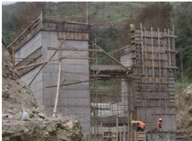
Figura No.2.9 Tanque de Carga Principal. 12
