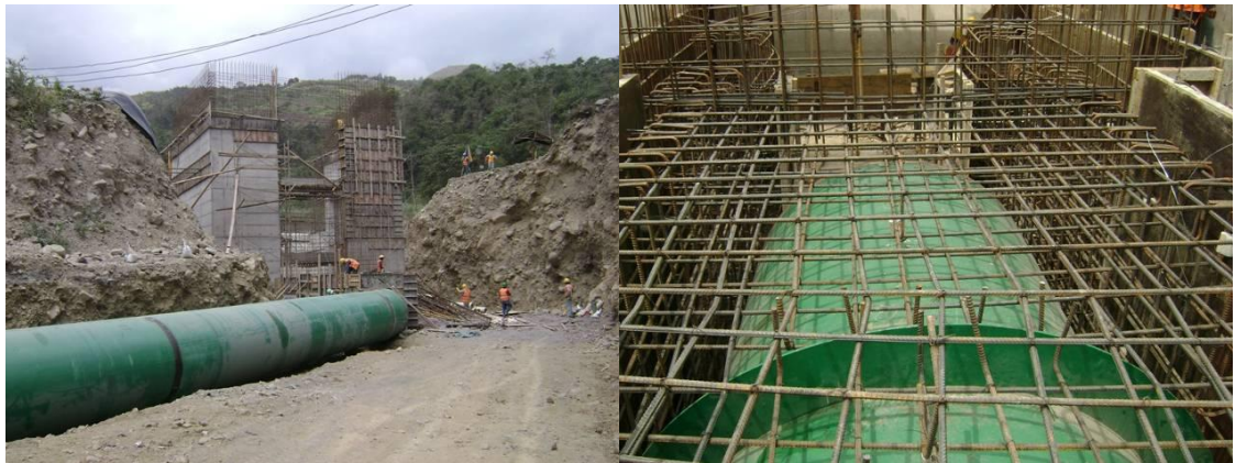
Figura No.2.10 Tubería de Baja Presión. 13
