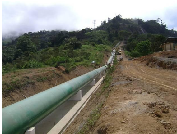
Figura No.2.13 Tubería de Presión. 16
