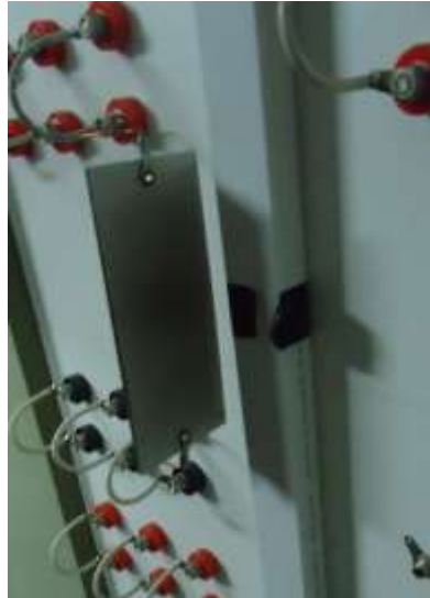
Foto 2.1. Carga resistiva instalada en el módulo. Elemento resistivo de 43 ohmios a 600 W. Fuente: (Autores)
