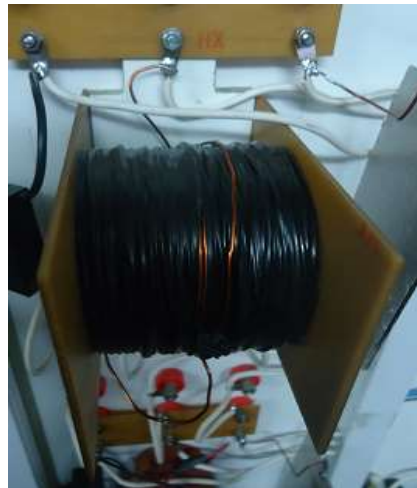
Foto 2.3. Carga puramente inductiva instalada en el módulo. Elemento inductivo de 54 mH a 5 A. Fuente: (Autores)
