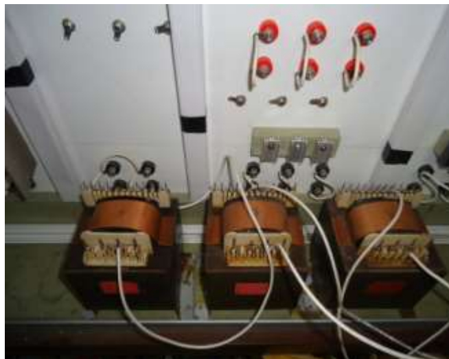
Foto 4.1. Banco de transformadores reductores. Tres transformadores conectados en estrella – estrella. Fuente (Autores).
