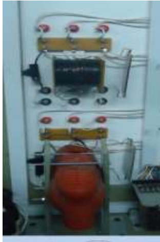
Foto 4.15. Vista del bloque de carga del panel posterior. Fuente: (Autores)
