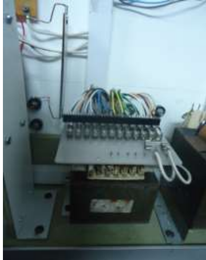
Foto 4.12. Transformador de la fuente de poder de 12V DC 600mA. Fuente: (Autores)
