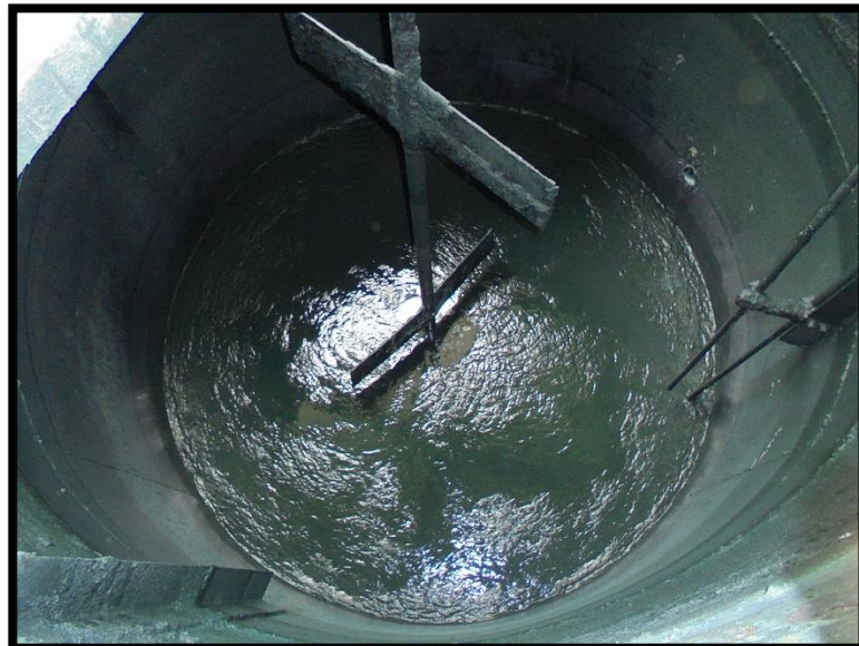
Figura 3.9 Tanque de floculación. Vista superior del agitador de floculación para la mezcla de los químicos. CARTOPEL S.A.I., (2015)
