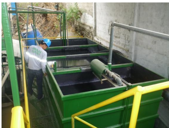
Fotografía 5.- Pre sedimentador antes del reactor mezclador
