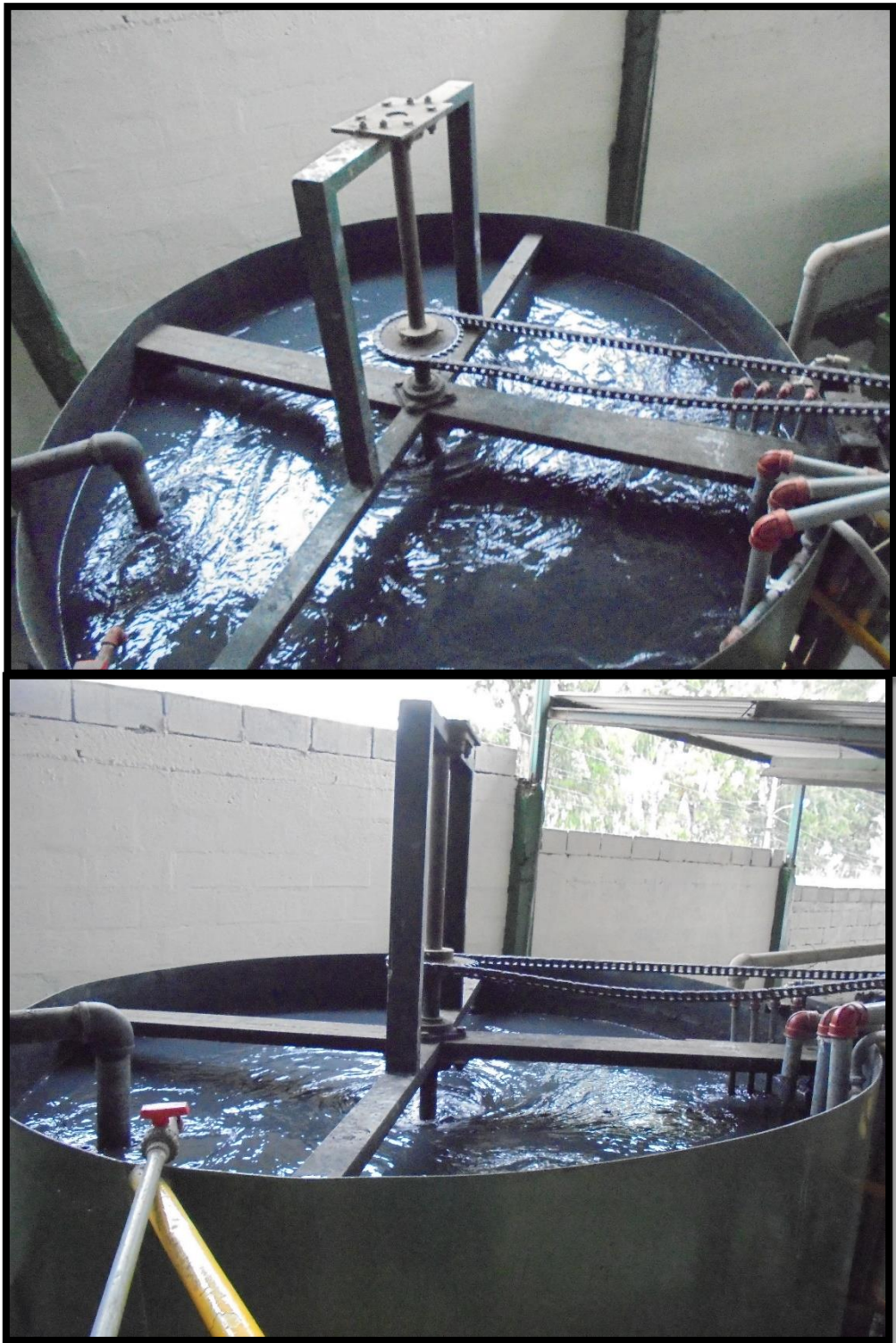
Figura 5.22 Agitación del agua de tinta en tanque de floculación. Agitación Automática.
