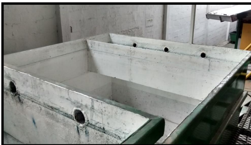
Figura 3.13 Tanque de sedimentación 2. Tanque con lámina filtrante de sólidos del agua final tratada y lista para ser desalojada al medidor de caudal. CARTOPEL
