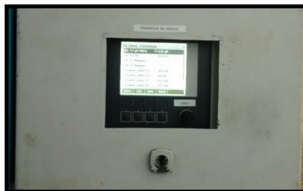
Figura 5.17 Tablero del transmisor de señales analógicas. Muestra las mediciones enviadas desde los sensores.
