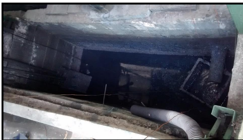
Figura 3.5 Cisterna de tinta. Cisterna de desperdicios de las aguas provenientes del lavado de las imprentas. CARTOPEL S.A.I., (2015)
