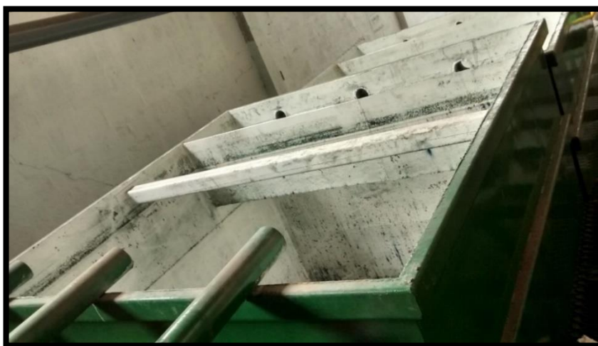
Figura 3.12 Tanque de sedimentación 1. Tanque con lamina filtrante de solidos del agua final tratada y lista para ser desalojada al tanque de sedimentación 2.
