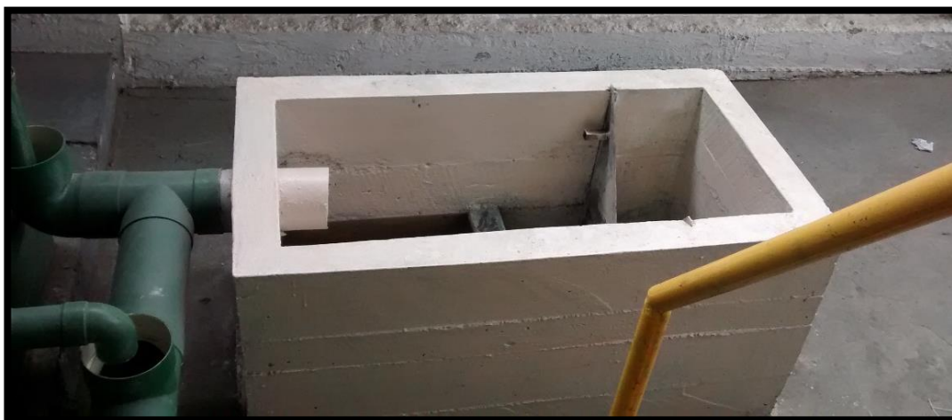
Figura 3.14 Depósito final del agua tratada. Depósito medidor de caudal del agua final hacia el sistema de alcantarillado público. CARTOPEL S.A.I., (2015)
