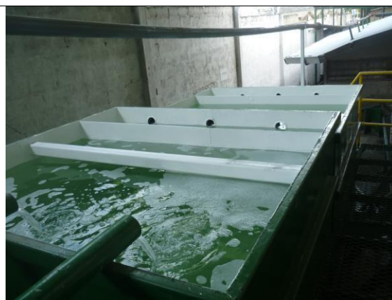
Fotografía 4.- Pre sedimentador secundario-En operación
