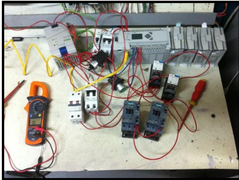
Figura 5.7 Prueba de funcionamiento. Prueba general entre el PLC y sus módulos
