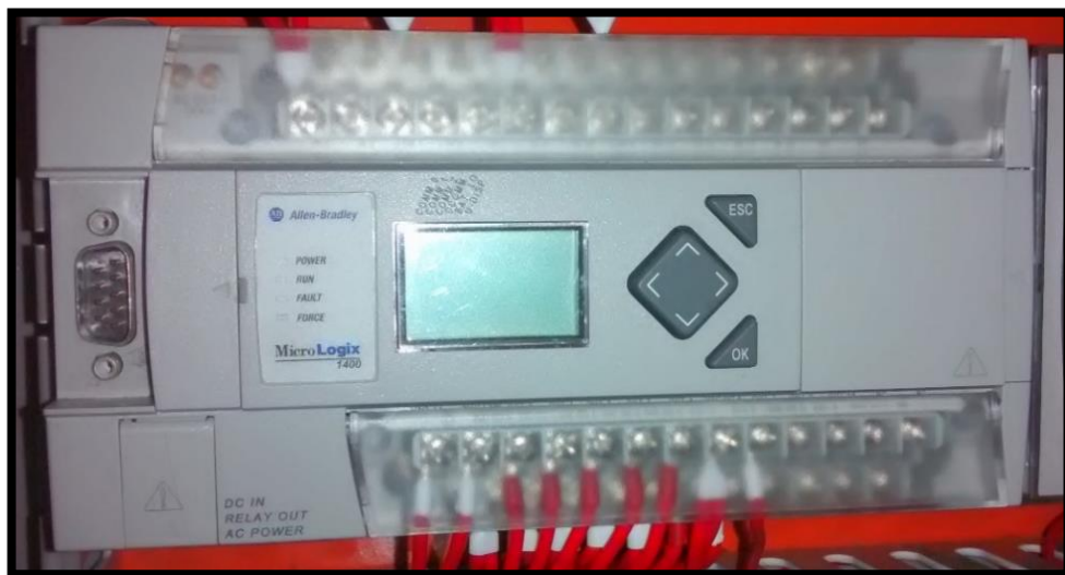
Figura 2.2: PLC Allen Bradley Micrologix 1400 1766 L32 BWA. Dispositivo controlador del proceso de aguas residuales CARTOPEL S.A.I. Por Allen Bradley, (2015)
