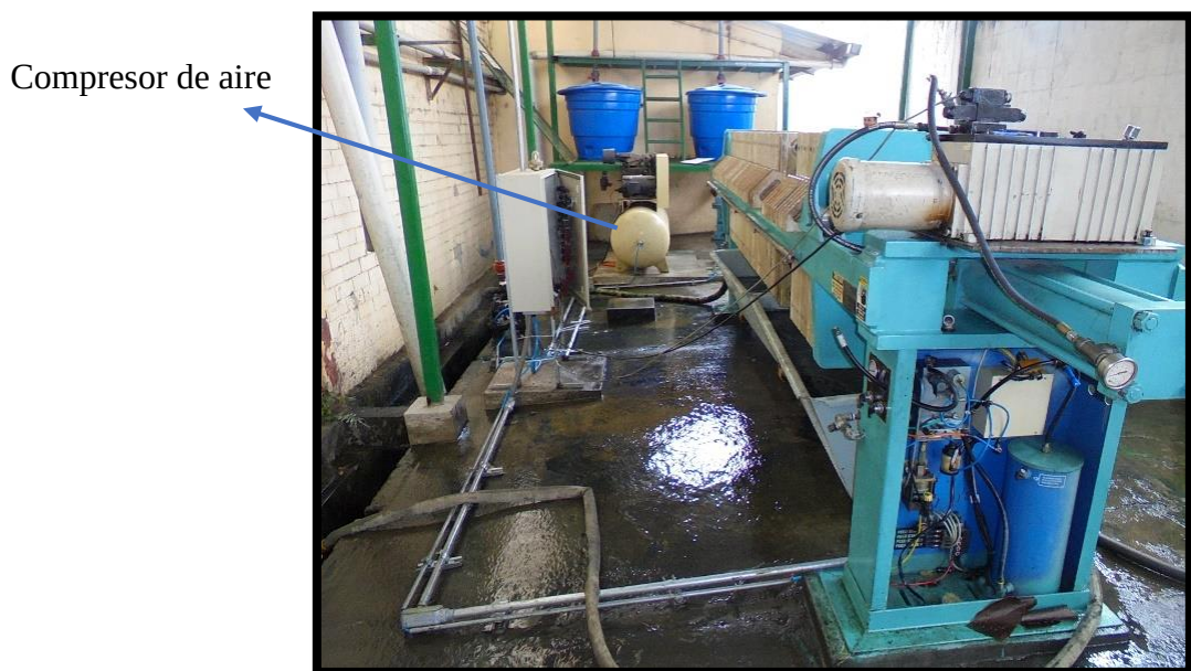
Figura 3.16 Estación del filtro prensa. Filtro del lodo del tratamiento del agua. CARTOPEL S.A.I., (2015)
