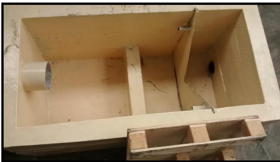
Figura 3.15 Depósito final del agua tratada. Vista superior de medidor de caudal del agua final. CARTOPEL S.A.I., (2015)
