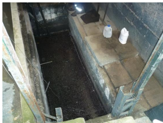
Fotografía 6.- Cáncamo de bombeo antes del pre sedimentador
