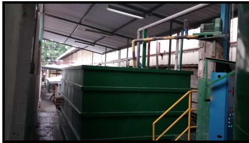
Figura 3.10 Tanque de aireación. Vista lateral del tanque donde se vierten las bacterias que disuelven los sólidos suspendidos. CARTOPEL S.A.I., (2015)
