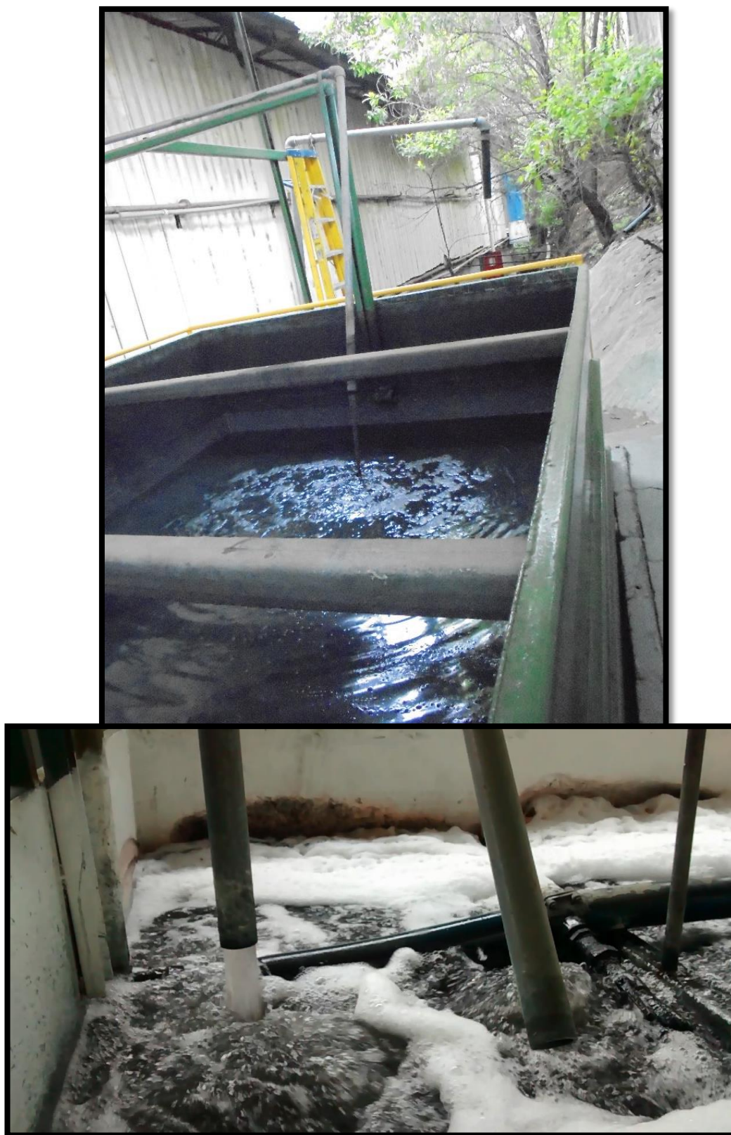
Figura 5.21 Alimentación de fluidos en los tanques del proceso. Llenado automático.
