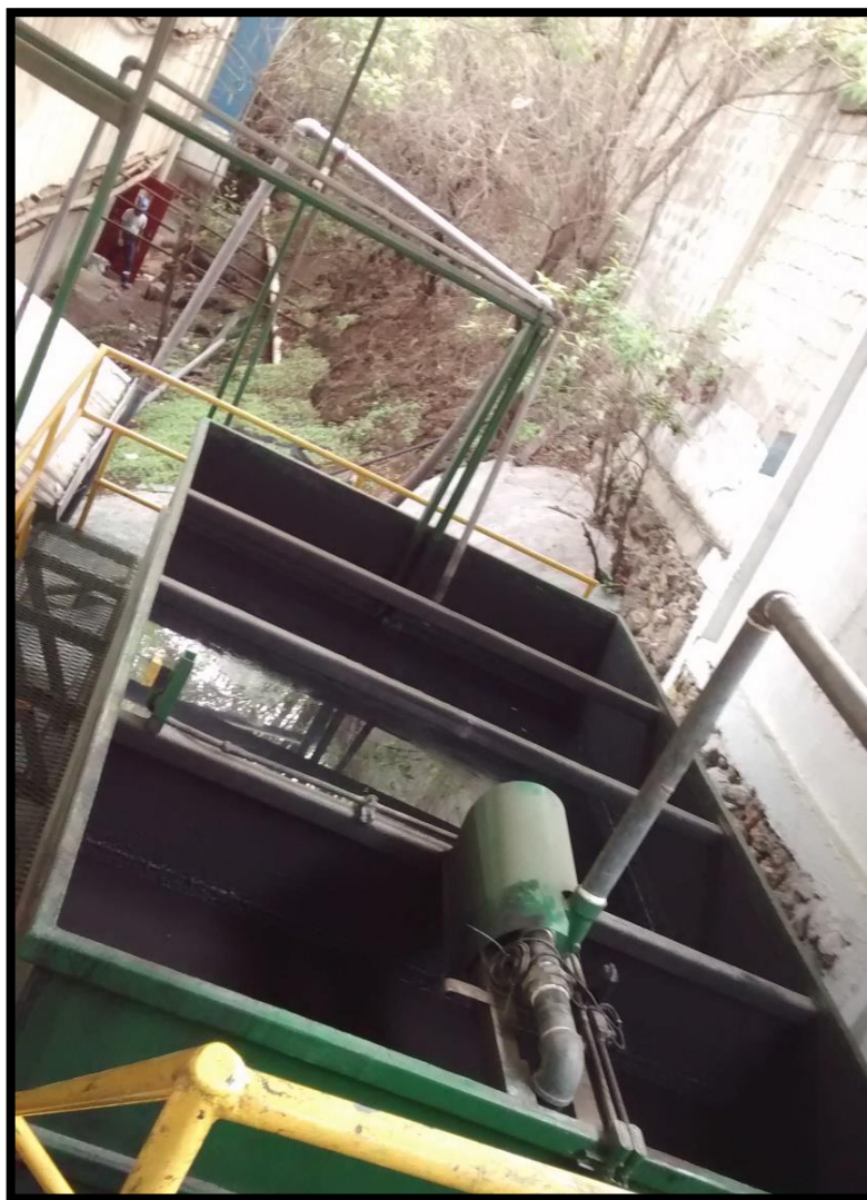
Figura 3.7 Tanque de homogenización. Vista superior de pantallas filtrantes y bomba del tanque de homogenización. CARTOPEL S.A.I., (2015)
