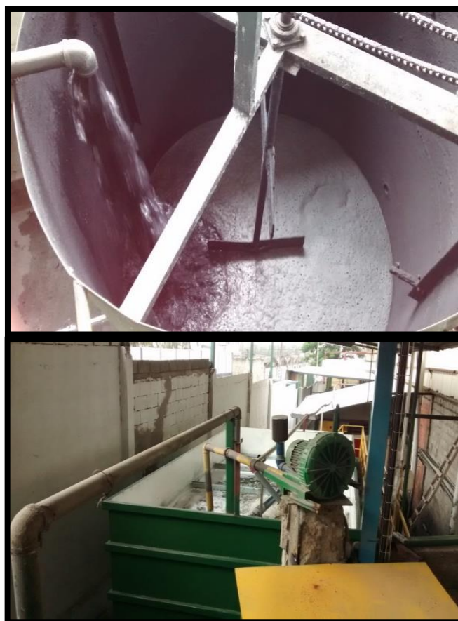
Figura 5.16 Pruebas generales en operación manual. Funcionamiento del encendido y apagado de las bombas y permisos y restricciones del proceso
