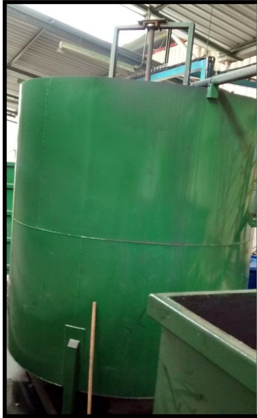
Figura 3.8 Tanque de floculación. Vista lateral del tanque de tratamiento del agua residual. CARTOPEL S.A.I., (2015)
