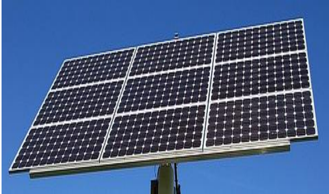
Figura 2: Panel de celdas fotovoltaicas.
