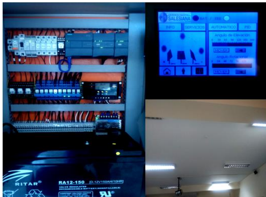
Figura 70: Estado de Iluminación con Alimentación de Respaldo.
