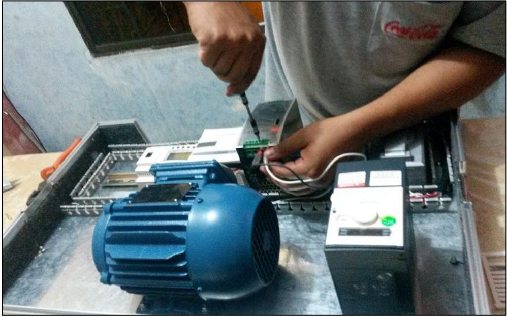
Figura 48. Montaje y Cableado de equipos. Se cablean los equipos tanto en su parte eléctrica como de comunicación.
