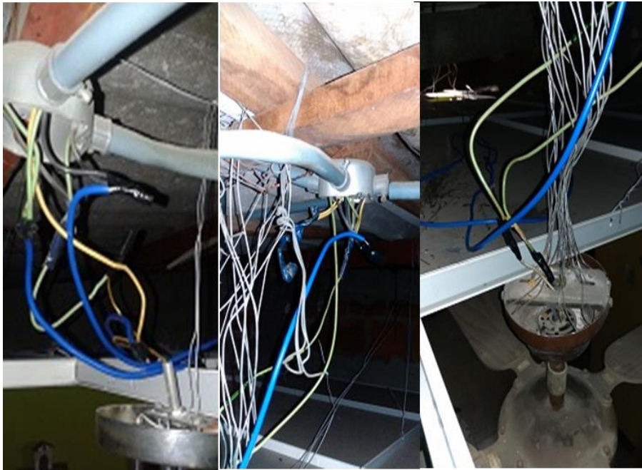
Anexo 15: Estado Actual de las conexiones eléctricas Fuente: Los Autores
