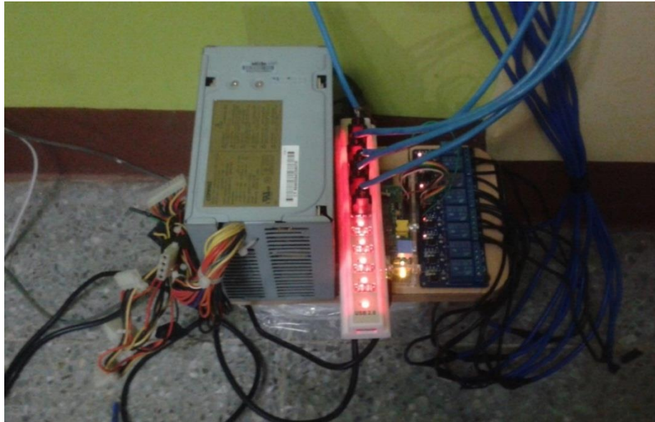
Anexo 19: Prueba Final Cámaras y Control de Luces Fuente: Los Autores
