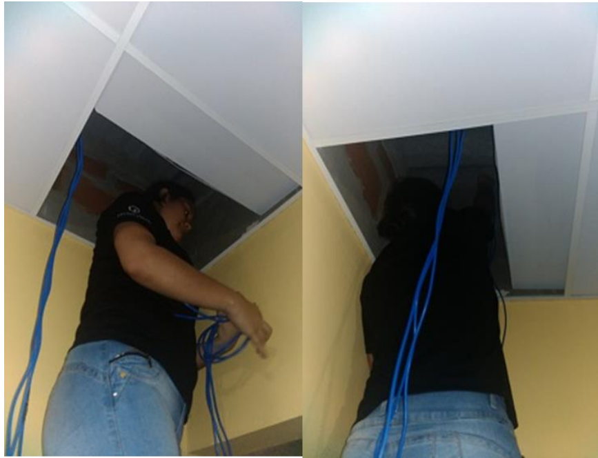
Anexo 17: Tendido Eléctrico Focos-Cocina Fuente: Los Autores
