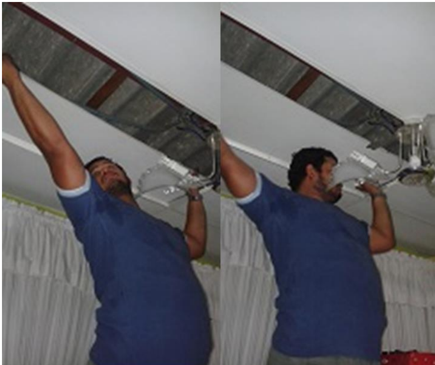
Anexo 16: Tendido Eléctrico Focos-Sala Fuente: Los Autores
