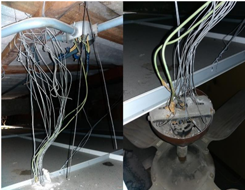
Anexo 14: Estado Anterior de las conexiones eléctricas Fuente: Los Autores
