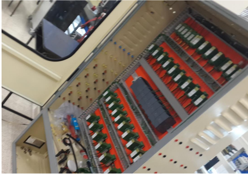
Figura 41: M.A.P.P.E. Cableado de todo los equipos. Parte 3. Fuente: Los Autores
