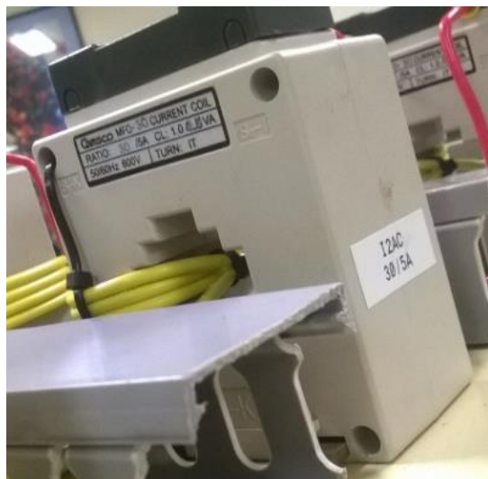
Figura 76: Transformadores de Corriente Fuente: Laboratorio de Motores y Generadores
