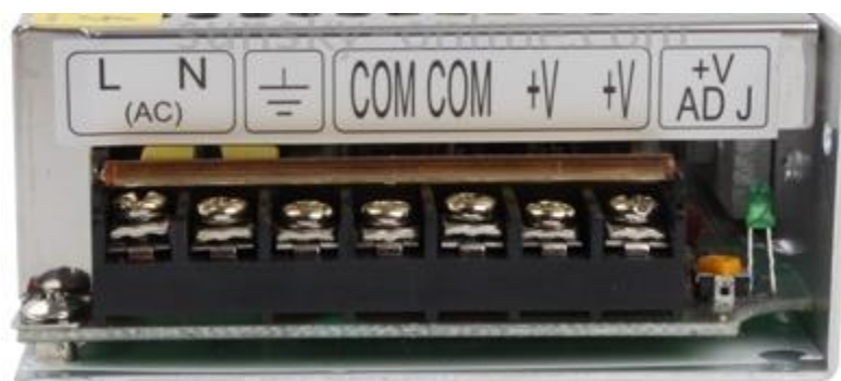
Figura 79: Fuente de Alimentación, Borneras y sus Simbologías de especificación Fuente: Los Autores
