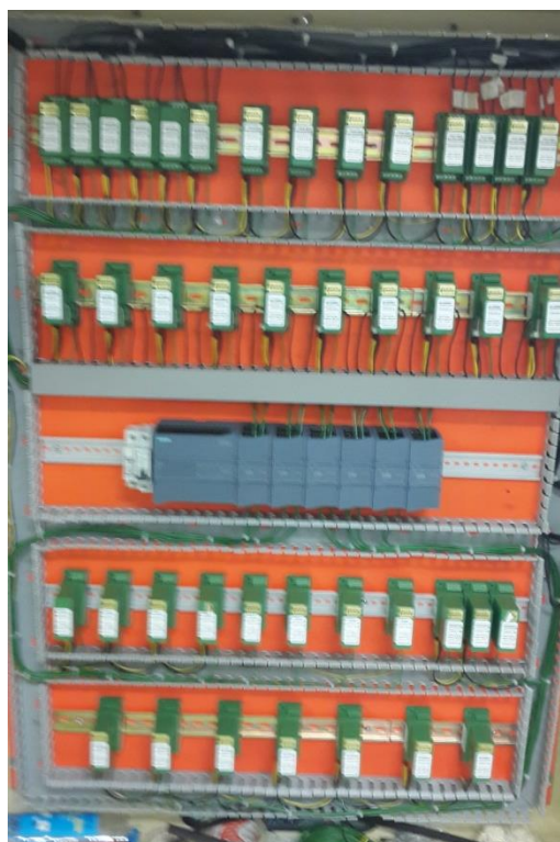
Figura 40: M.A.P.P.E. Cableado de todo los equipos.
