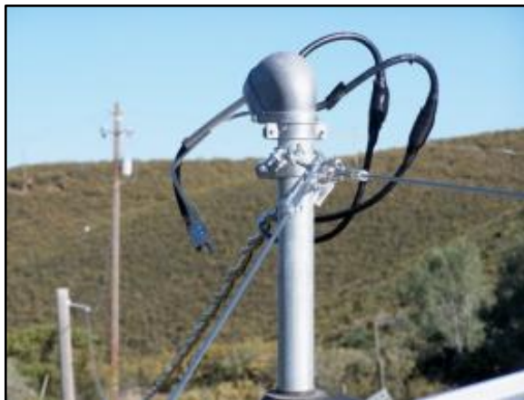
Figura 19: Acometida eléctrica habitual. Esta figura muestra el tubo y el reversible (mufa), elementos externos en una acometida aérea. Recuperado el 24 de abril del 2015, de http://i.mkt.lu/cont/1167579/280/240/mufa.jpg
