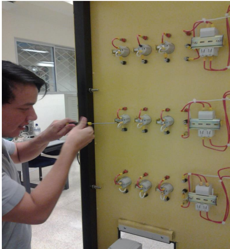
FIGURA 3. 5 Vista posterior del banco de pruebas.
