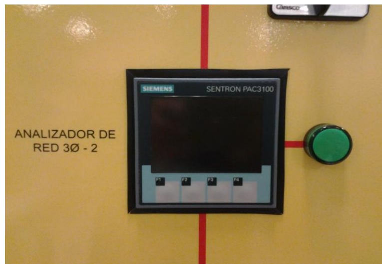
FIGURA 4. 6 Analizador de red trifásico
