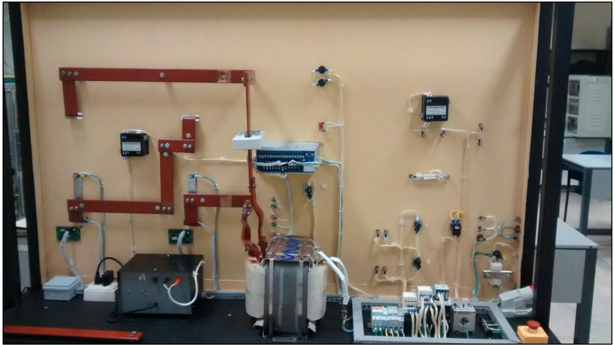
Figura 40 Vista posterior del módulo de protecciones de sobrecorriente para alimentadores de media tensión.
