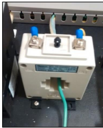
Figura 61 Transformador de corriente 30/5
