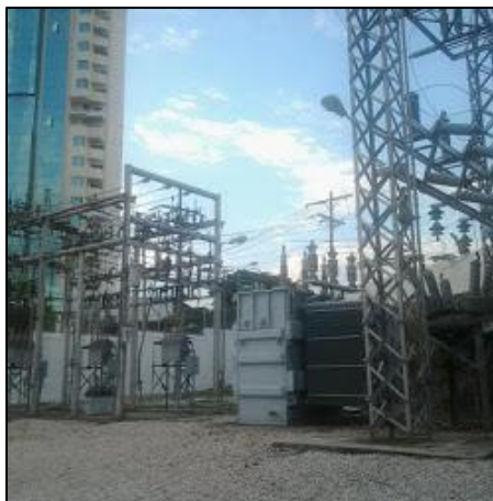
Figura 9 Subestación de distribución, Las Cumbres, Guayaquil, Ecuador.
