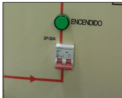
Figura 44 Breaker principal de fuerza del tablero.
