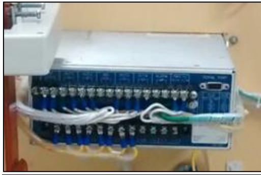
Figura 51 Vista posterior relé de sobrecorriente / Recierre SEL-551.
