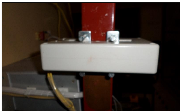
Figura 62 Transformador de corriente 2000/5
