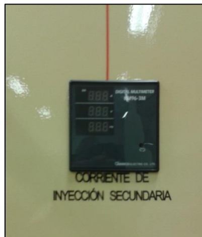
Figura 47 Vista frontal de medidor de parámetros 2.
