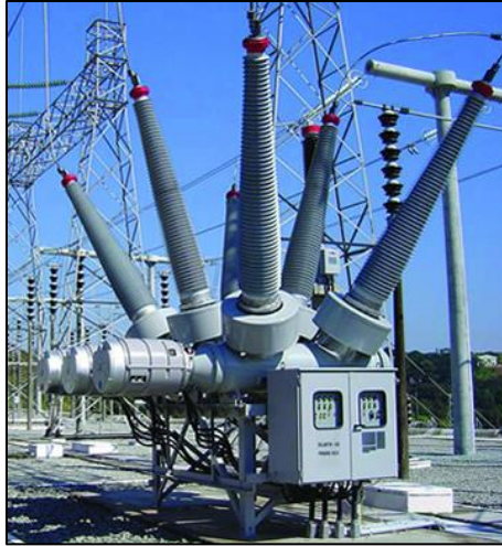
Figura 16 Interruptor ABB tanque muerto.
