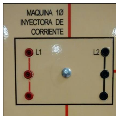
Figura 43 Borneras para alimentación eléctrica al tablero desde el variac.
