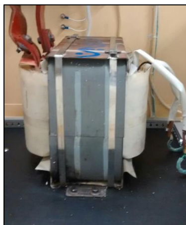
Figura 53 Transformador seco inyector de corriente de prueba.
