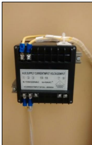
Figura 48 Parte posterior del medidor de parámetros 2.
