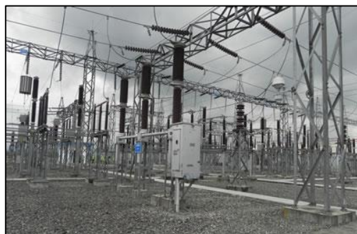
Figura 8 Subestación de maniobra, Ibarra, Ecuador.
