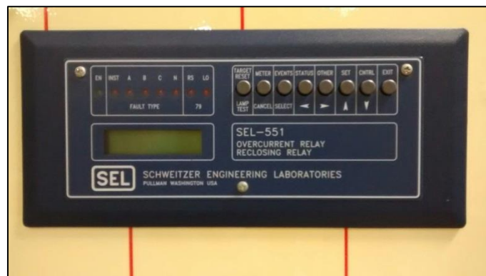
Figura 50 Vista frontal relé de sobrecorriente / Recierre SEL-551.
