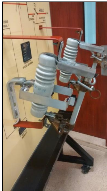
Figura 67 Cajas portafusibles 100 A
