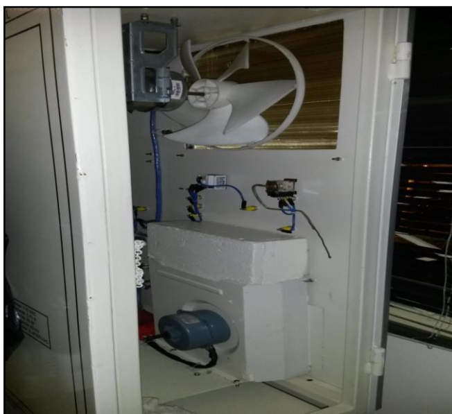
Figura 57 Motor ventilador evaporador y motor ventilador condensador
