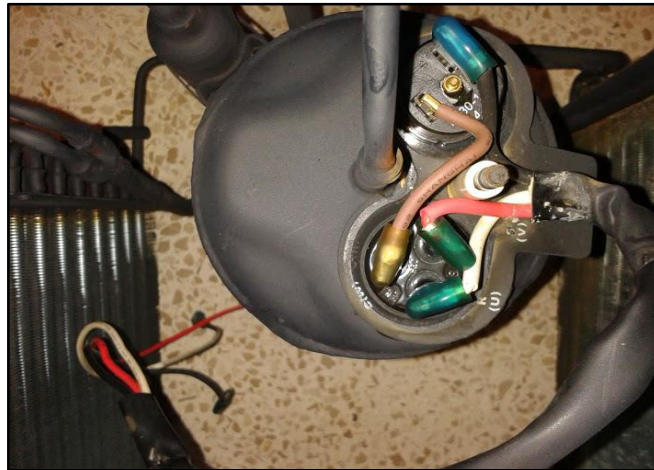
Figura 52 Terminales del compresor y protector térmico
