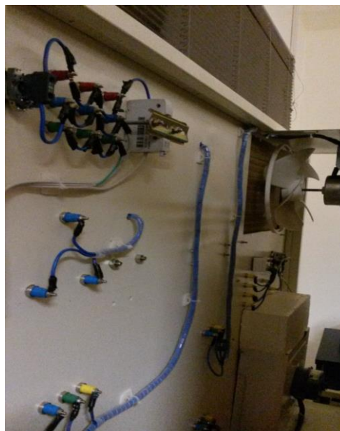
Figura 61 Conexión interna del disyuntor, barra de alimentación y capacitor
