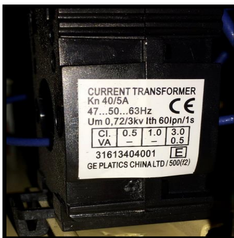
Ilustración 3.13 Transformador de corriente marca Volto
