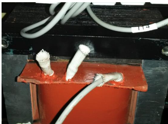
Ilustración 3.3 Transformador monofásico 1KVA
