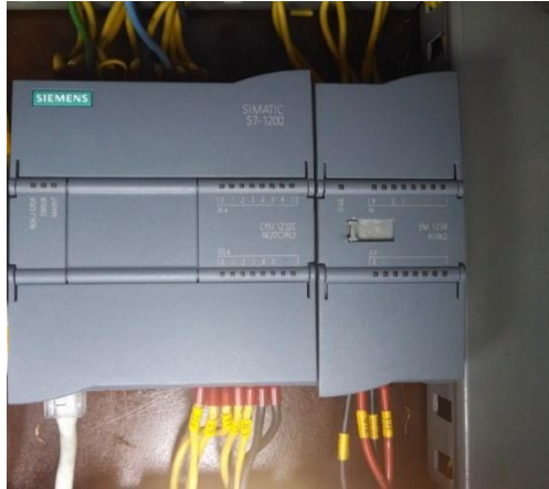
Figura 42. Montaje PLC s7-1200 Elaborado por: Amaya Danilo y
