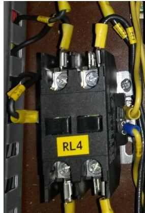
Figura 26. Contactor General Electric Elaborado por: Amaya Danilo.
