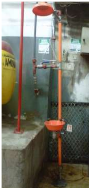
Fotografía 6: Ducha de emergencia
