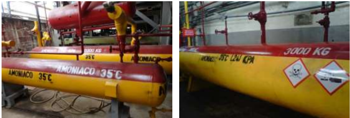
Fotografía 5: Almacenamiento de Amoníaco
