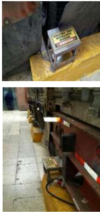
Fotografía 7: Conexiones eléctricas protegidas
