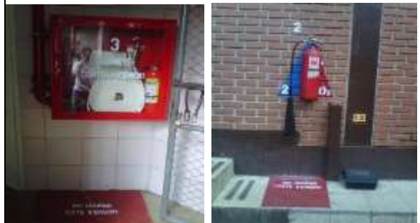
Fotografía 3: Gabinete contra incendios y extintores
