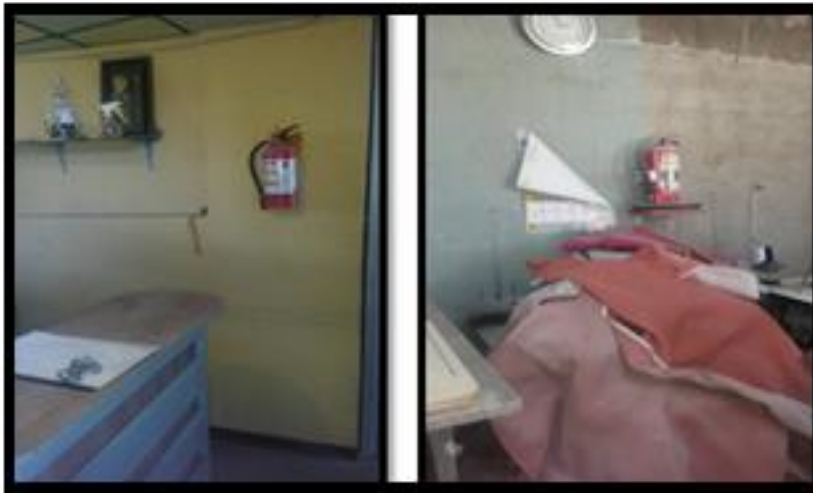
Figura 11. Ubicación de los extintores en las oficinas. Elaborado por: S. Fonseca & G.Haro.
