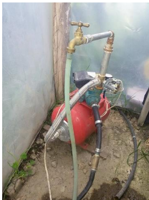
Foto 2. Sistema de conducción de Agua.
