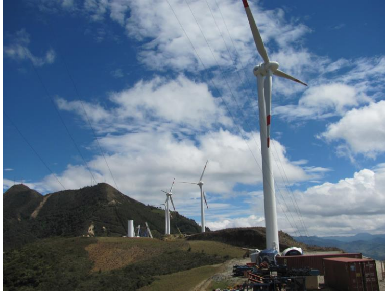
Figura 1.12. Central Eólica Villonaco.
