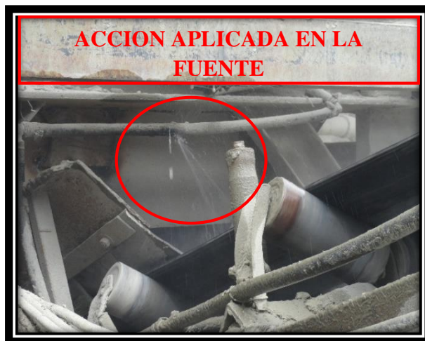
Ilustración 51. Rociador de agua en las bandas de la trituradora Fuente. Los Autores.
