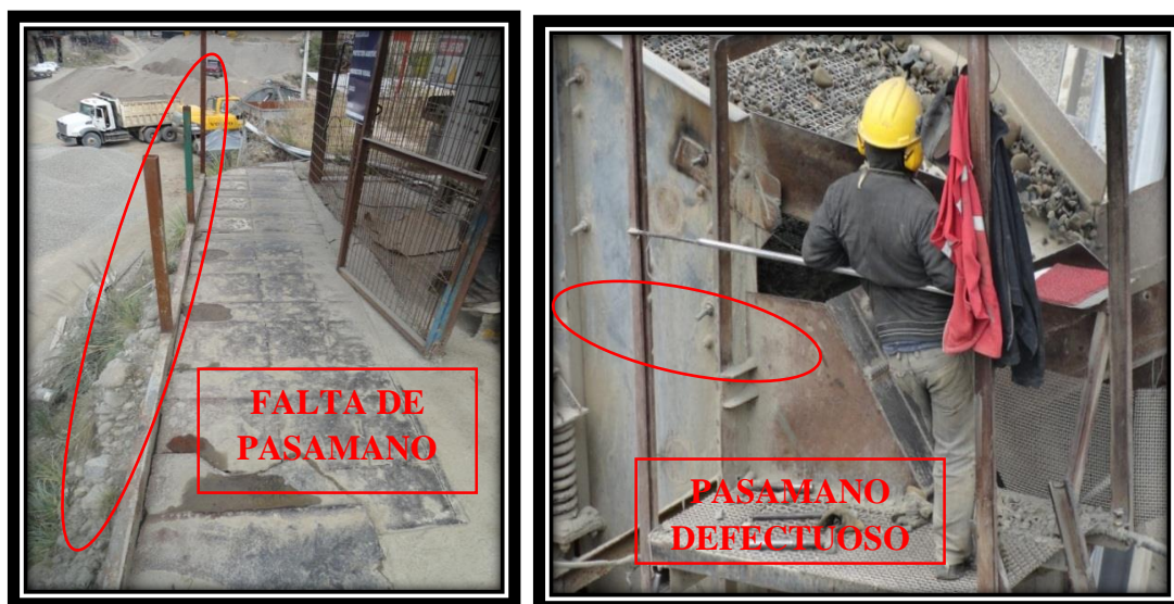
Ilustración 24. Área de Triturado, Riesgos de Caídas. Fuente: Los Autores.
