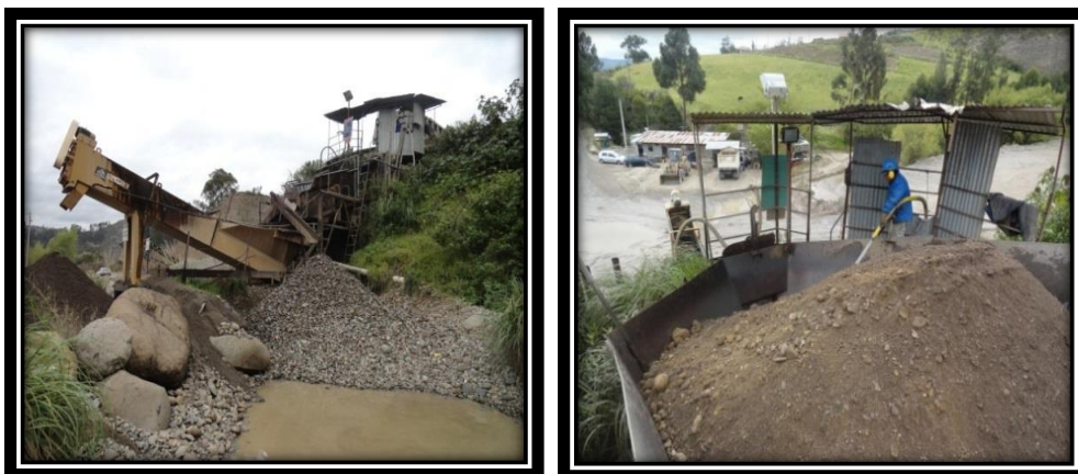
Ilustración 16. Área de Clasificación Vibratoria y Lavado de Lastre. Fuente: Los Autores.
