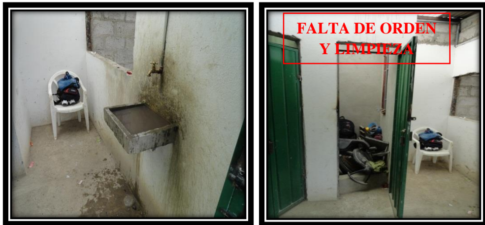
Ilustración 29. Área de Servicios Higiénicos Fuente: Los Autores.
