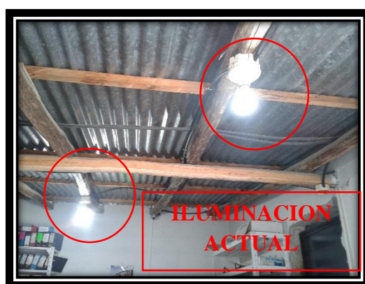
Ilustración 50. Iluminación actual del Área Administrativa. Fuente: Los Autores
