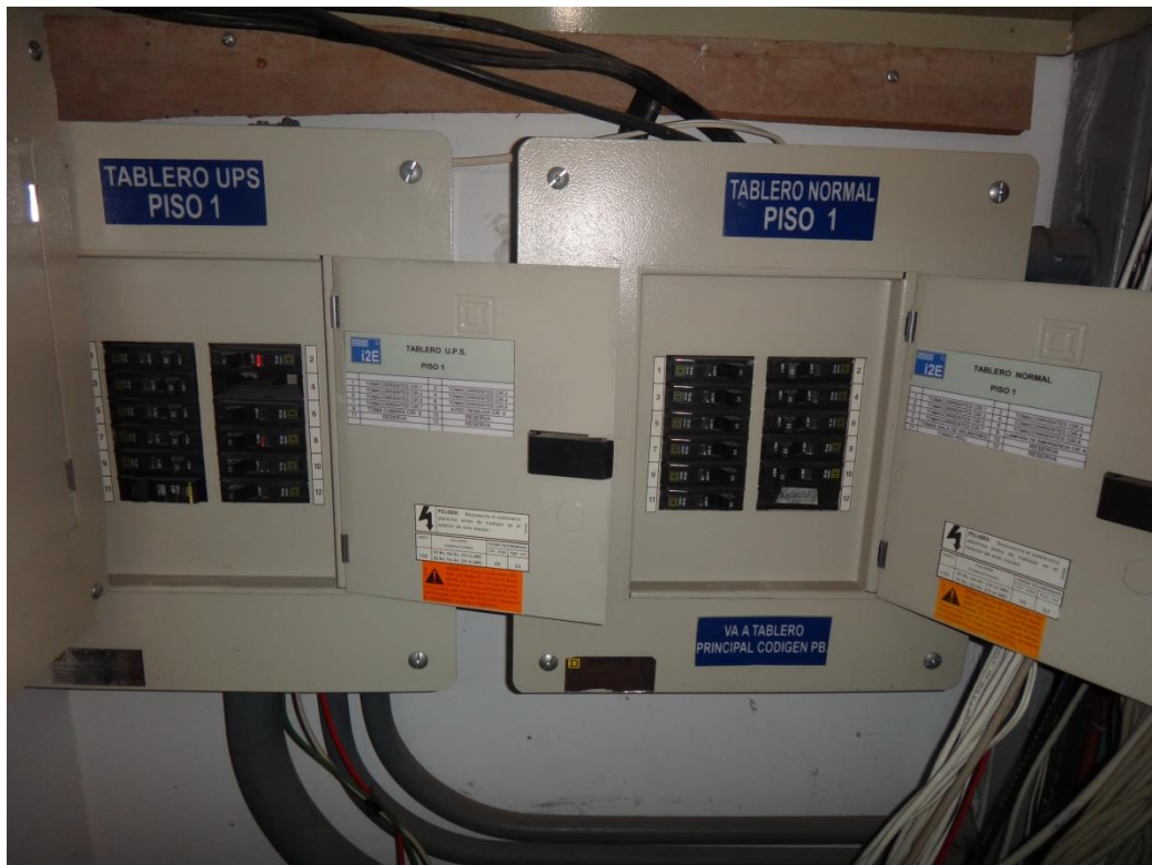
Figura 2 Caja de breakers del primer piso del Edificio Páez 657.
