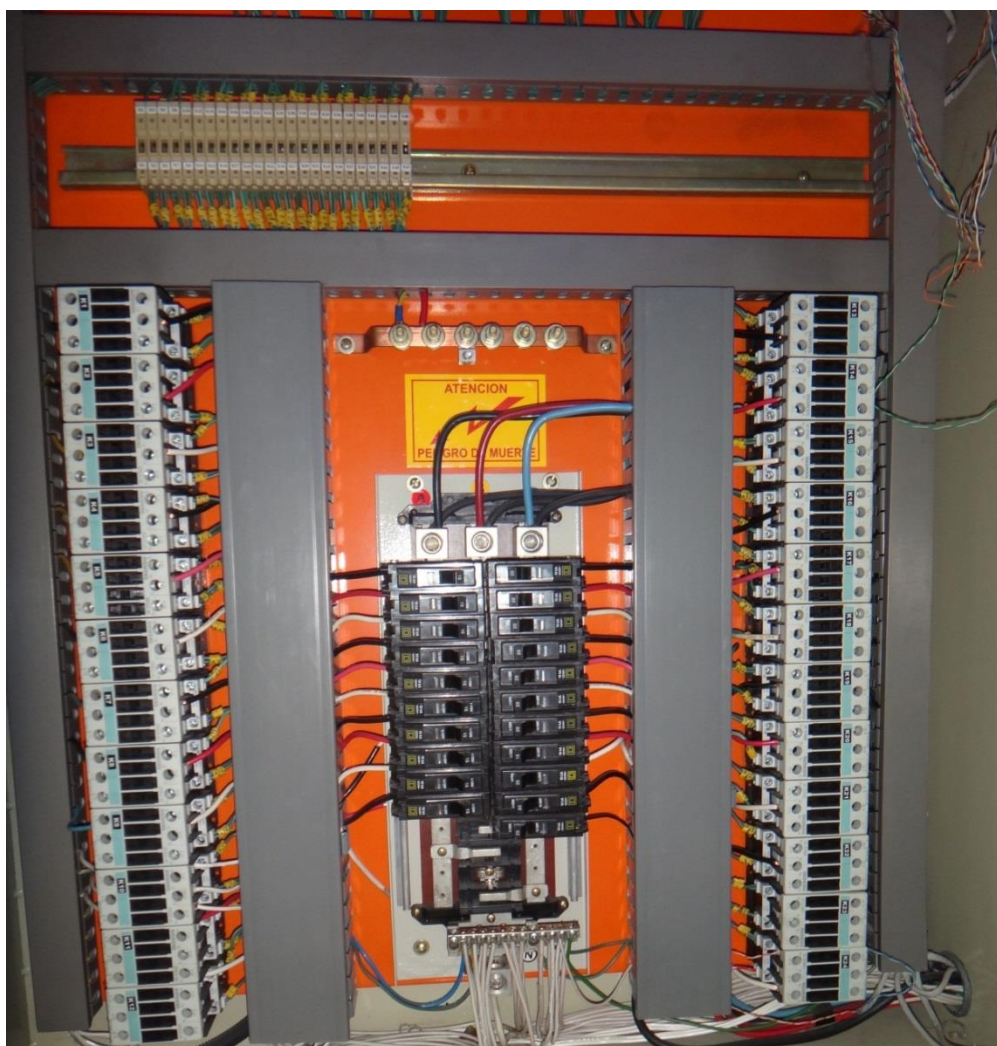
Figura 38. Conexión de los: contactores, relés y los disyuntores en el tablero principal ubicado en la agencia Páez 657
