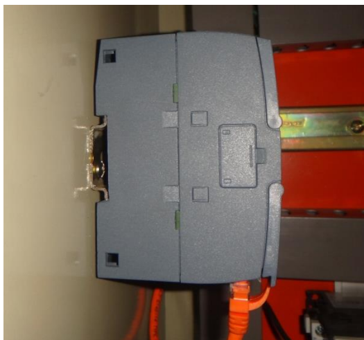
Figura 34. Montaje horizontal del PLC S7-1200 en un perfil de rail DIN en la agencia Páez 657
