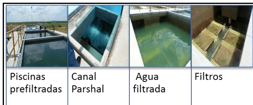
Imagen 4: Infraestructura del proceso de Potabilización de Agua
