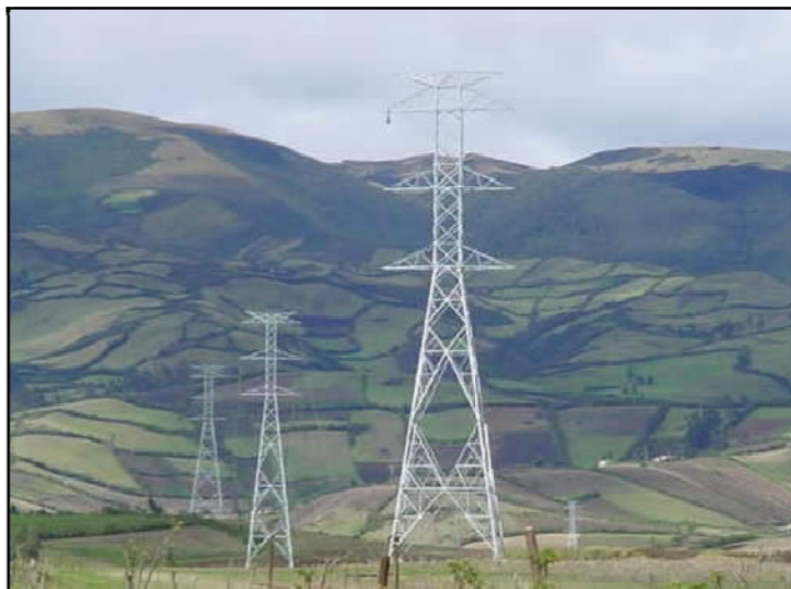
Fig. N° 1.4-2: Torre de suspensión.
