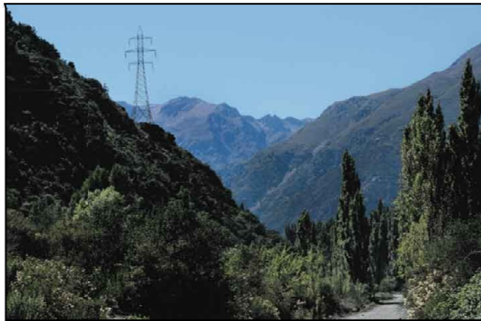
Fig. N° 1.2-8: Torre auto soportada en escarpados.
