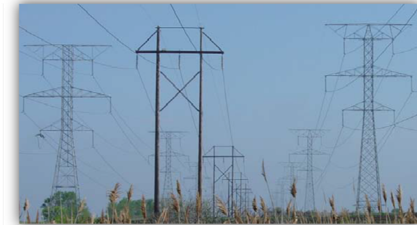
Fig. N° 1.2-1: Torres de Transmisión eléctrica.
