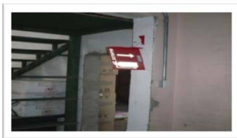
Ausencia de Sistema de Incendios Emergencias
