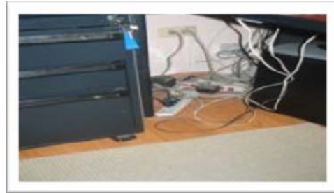
Instalaciones Eléctricas Defectuosas
