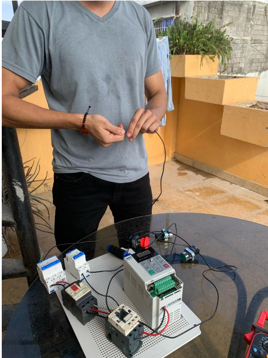
Figura 110. Conexiones para prueba de arranque. Fuente: Elaborado por autores.
