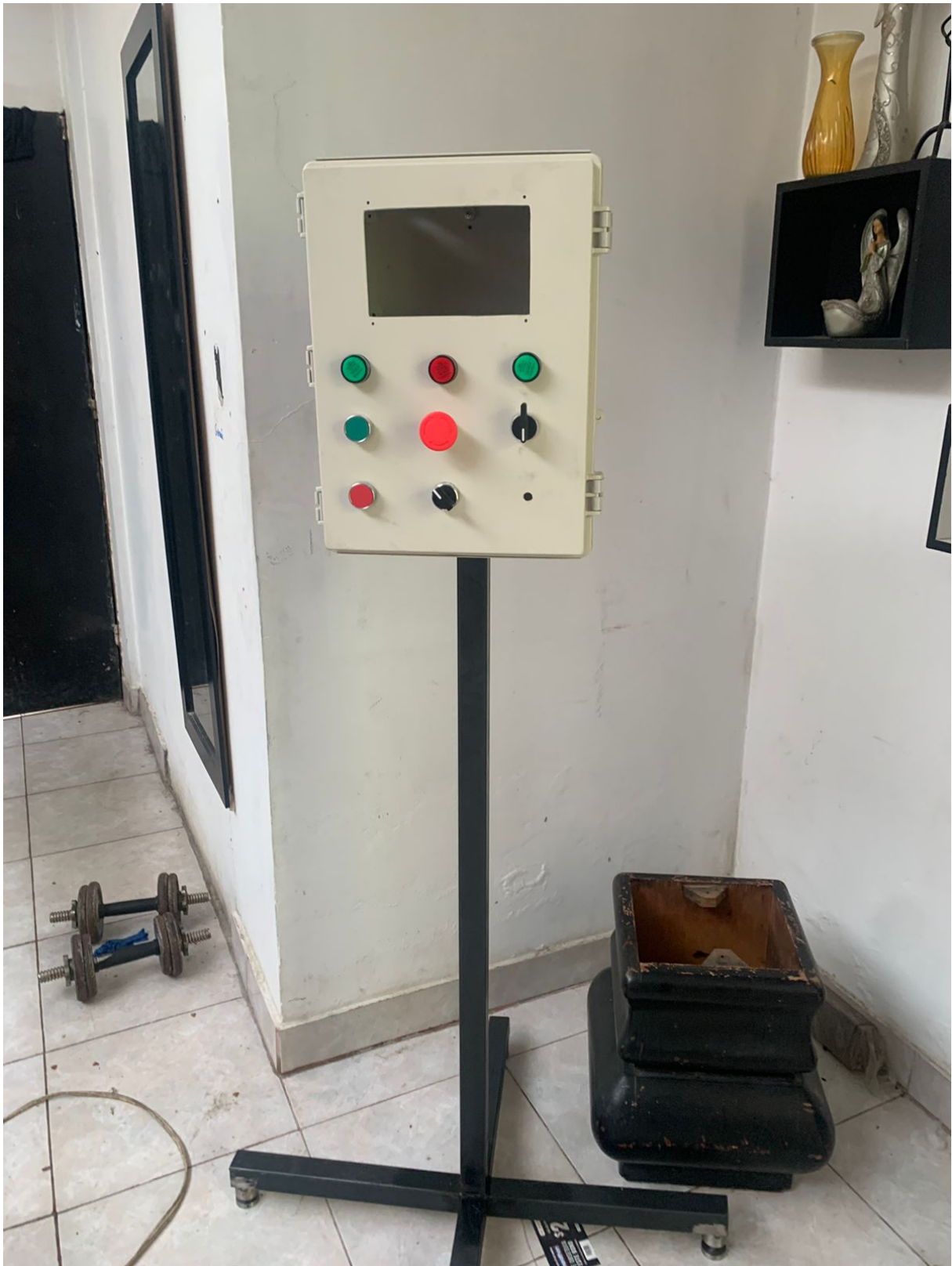
Figura 116. Panel de control con soporte. Fuente: Elaborado por autores.
