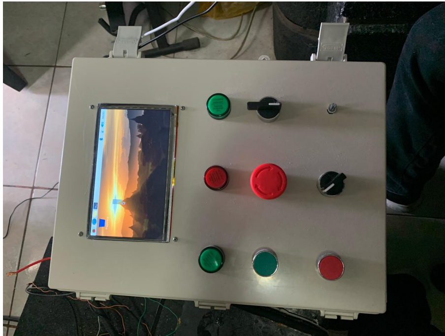
Figura 114. Implementación de pantalla y botonera en tablero. Fuente: Elaborado por autores.
