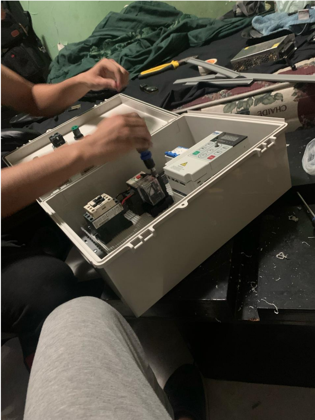
Figura 111. Conexión de componentes en caja eléctrica. Fuente: Elaborado por autores.
