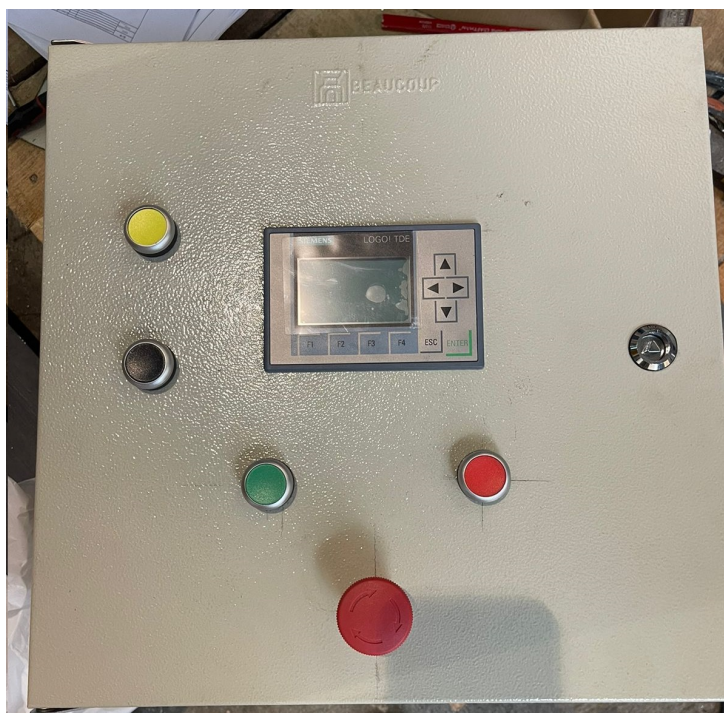
Figura 55: Tablero eléctrico. Fuente: Autoría Propia.
