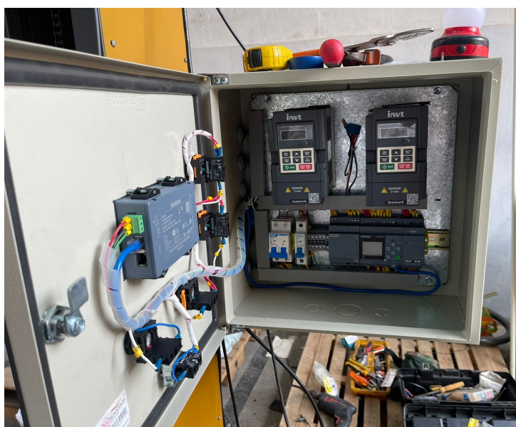
Figura 56: Conexiones internas del tablero eléctrico. Fuente: Autoría Propia.
