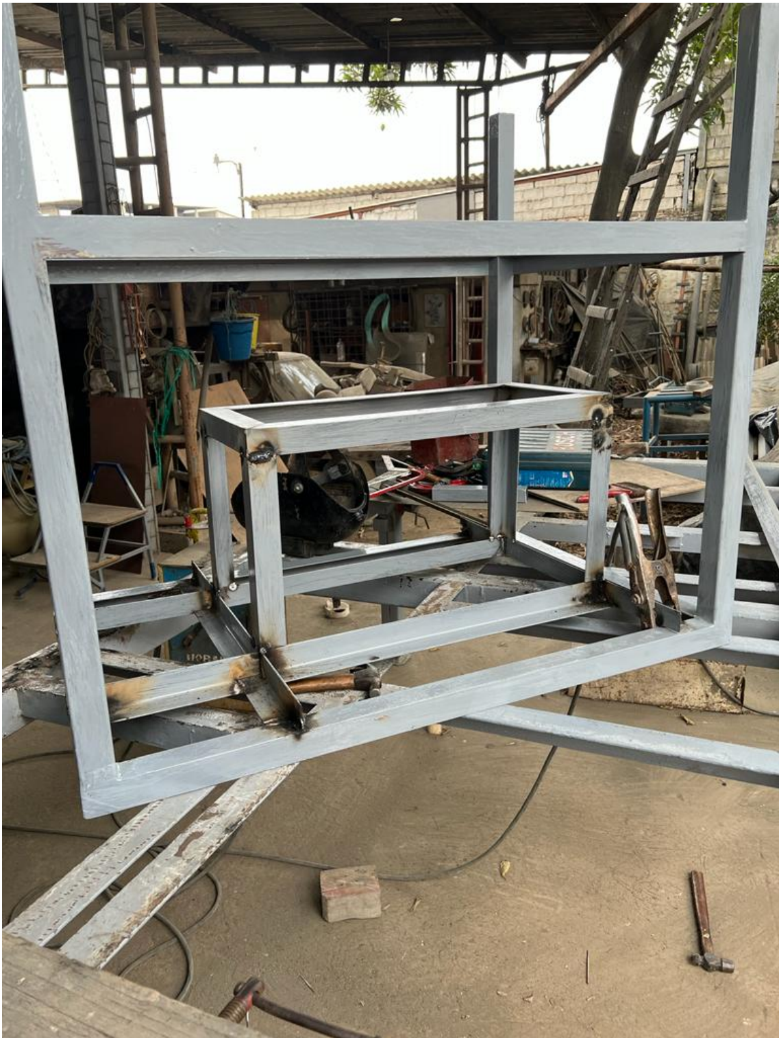
Figura 100. Incorporación de la jaula para el soporte de la banda transportadora, por A. Valarezo y R. Izquierdo.
