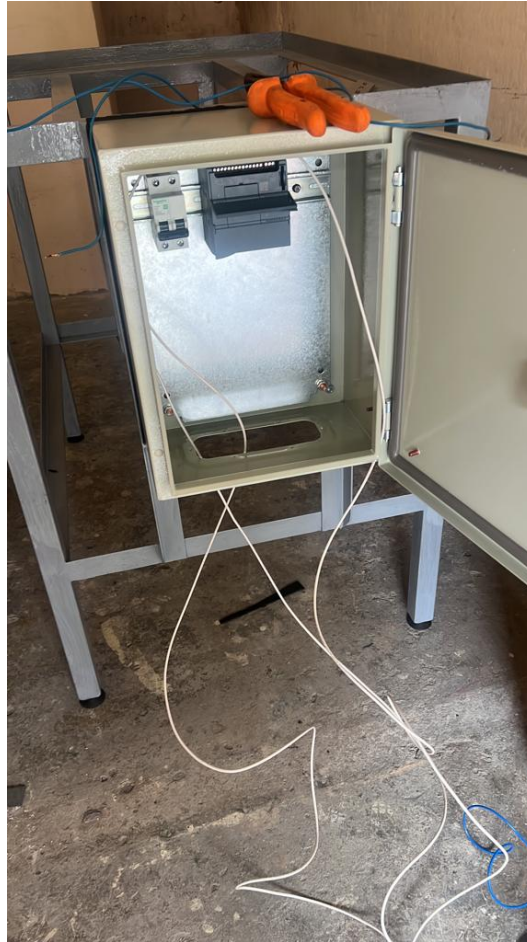
Figura 68. Prueba Piloto para verificar el correcto funcionamiento del PLC dentro de la caja de distribución, por A. Valarezo y R. Izquierdo.
