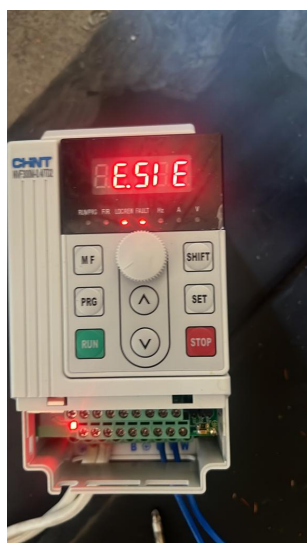
Figura 89. Error de prueba en el variador de frecuencia por mala conexión de las líneas, por A. Valarezo y R. Izquierdo.
