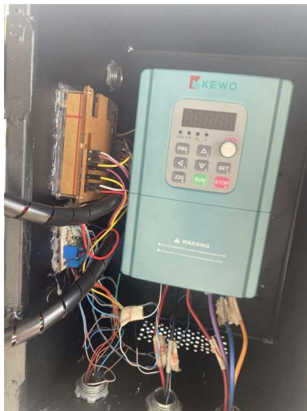
Figura 20. Conexiones internas, fuente autores.
